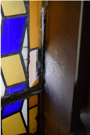
Figura 39: Mal estado de los ventanales
