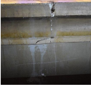
Figura 38: Escorrentías en las repisas de los ventanales
