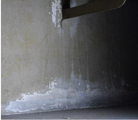
Figura 43: Daños provocados por el anclaje de las bancadas del coro
