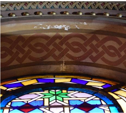
Figura 37: Grieta en la zona de los arcos de los ventanales
