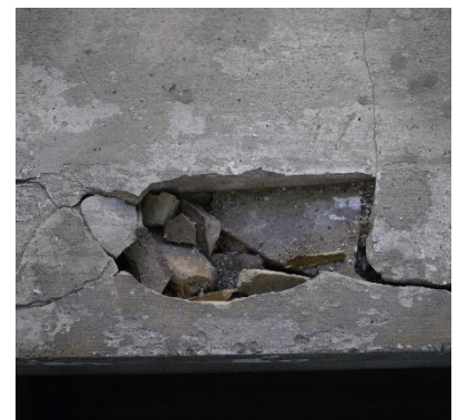
Figura 42: Daño en una de las repisas
