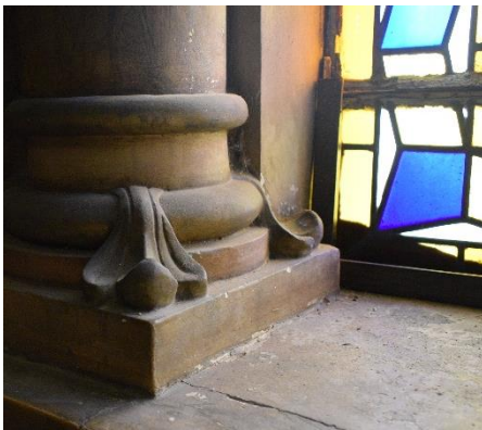
Figura 44: Telarañas en los recovecos de las columnas
