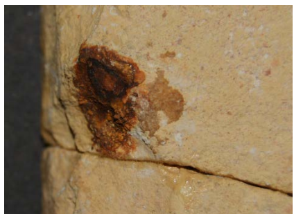
Fig. 28: Reverso del azulejo C-AZ-26 donde se observa una mancha de óxidos.
