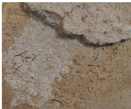
Fig. 26: Reverso del azulejo C-AZ-18 donde se observan restos biológicos además de mortero de colocación.
