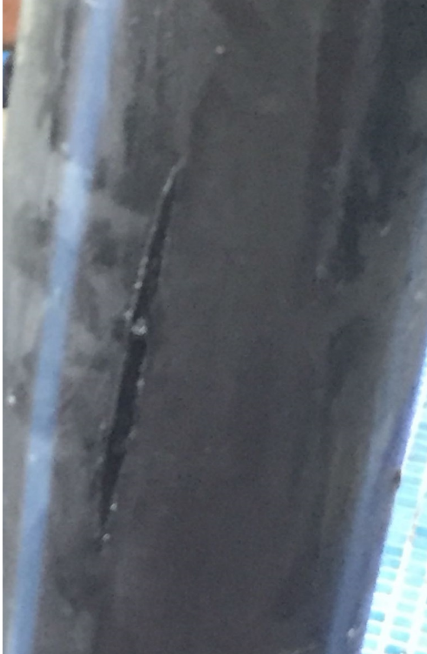
Figura 85. Imagen del defecto longitudinal.
