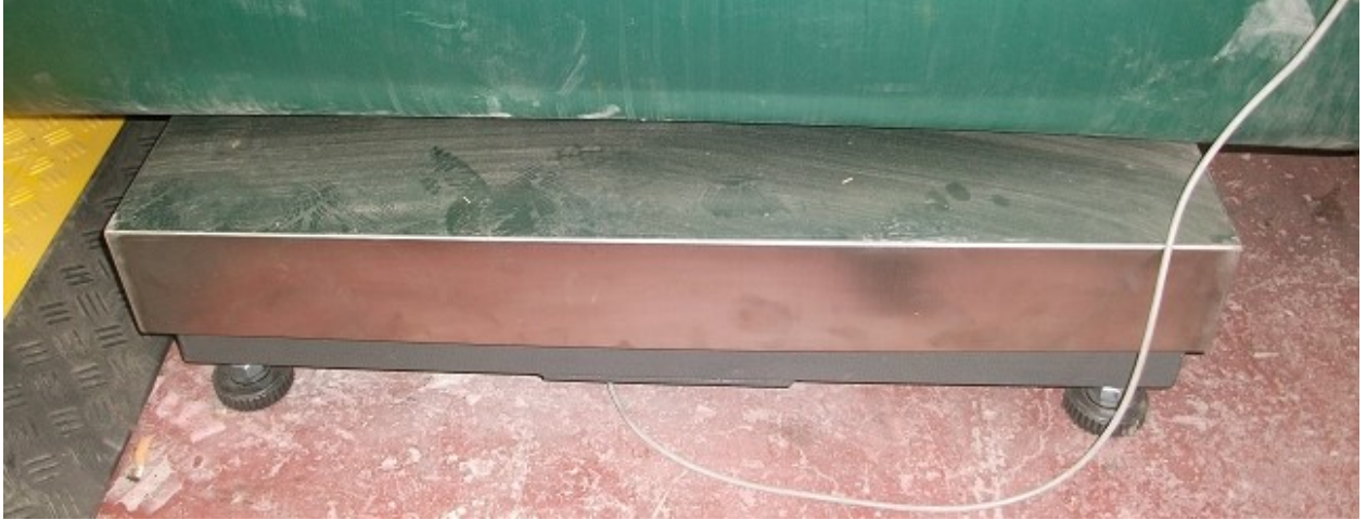
Figura 51. Foto de la báscula instalada bajo el depósito no presurizado.
