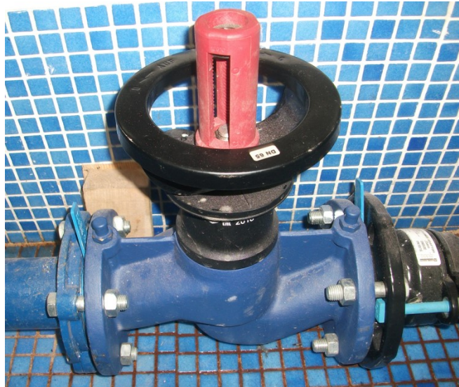
Figura 46. Válvula reguladora de caudal instalada en el banco de ensayos.
