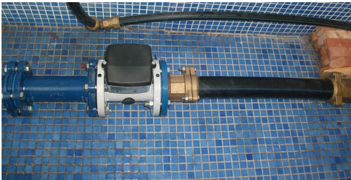
Figura 33. Caudalímetro instalado en el banco de pruebas con sus distancias necesarias de funcionamiento.
