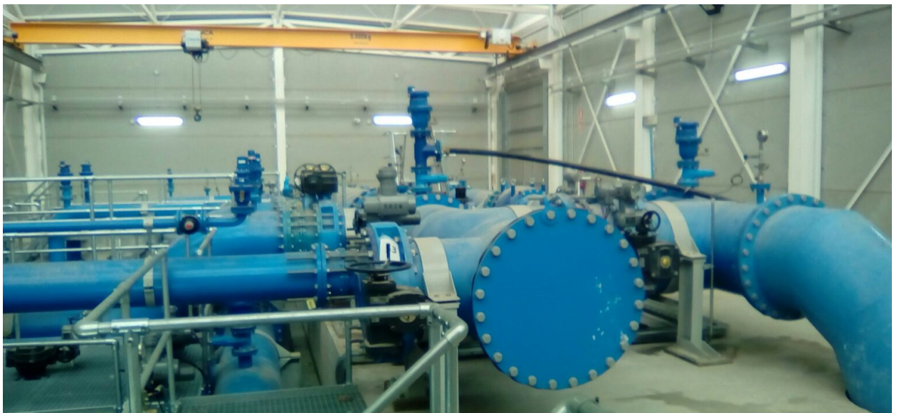
Tuberías de diámetro 300mm en adelante, en el kilómetro 0.
