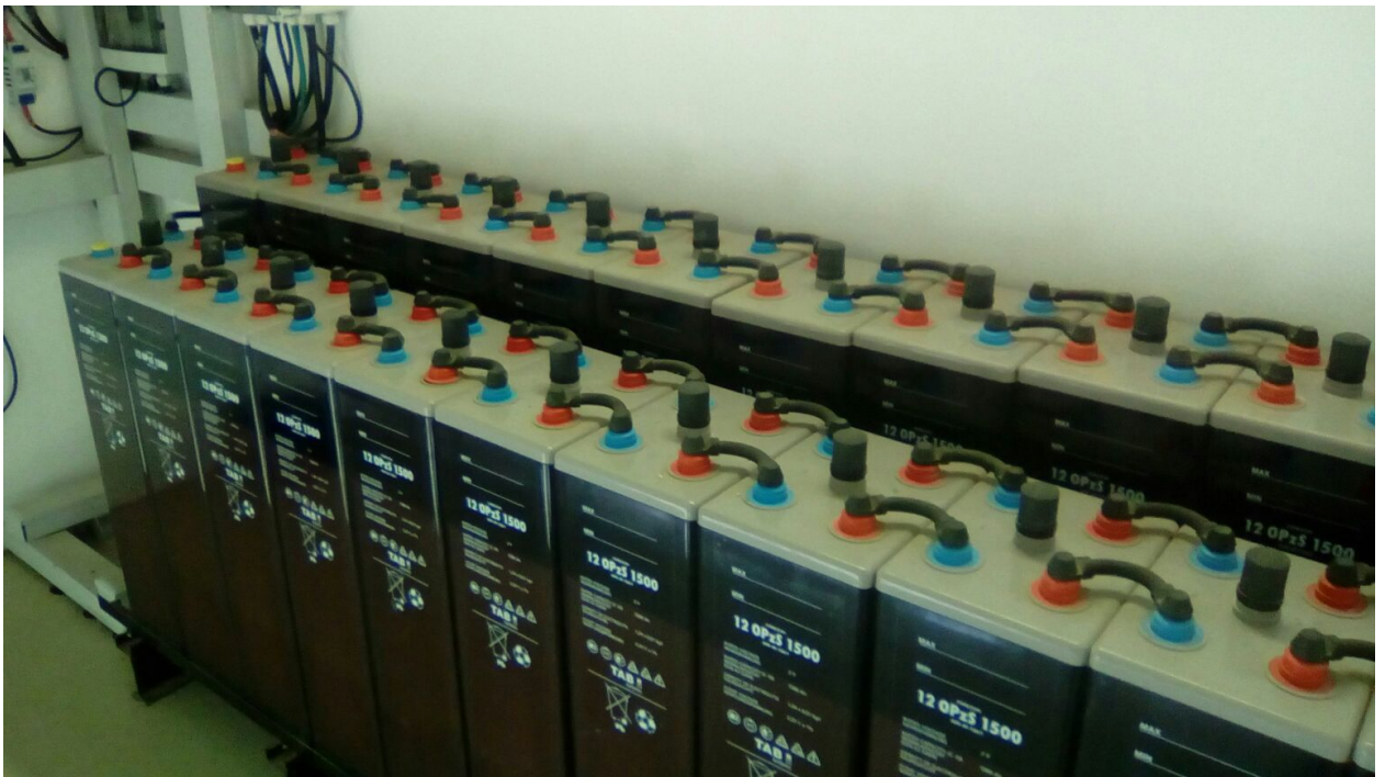
Sistema fotovoltaico del depósito. Suministra la energía necesaria para los elementos auxiliares (luz, bomba del sistema clorador, sensores y sistemas electrónicos, etc.).
