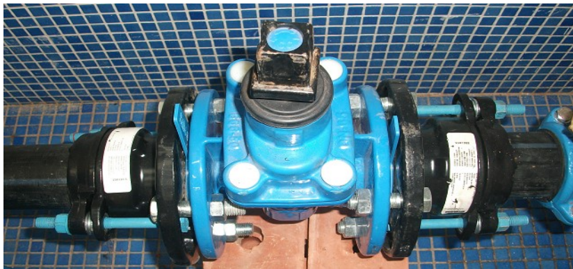
Figura 49. Detalle de la válvula de corte para aislar el cajón con el defecto.
