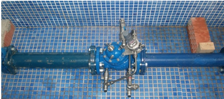
Figura 30. Válvula reguladora de presión usada en el banco de pruebas.
