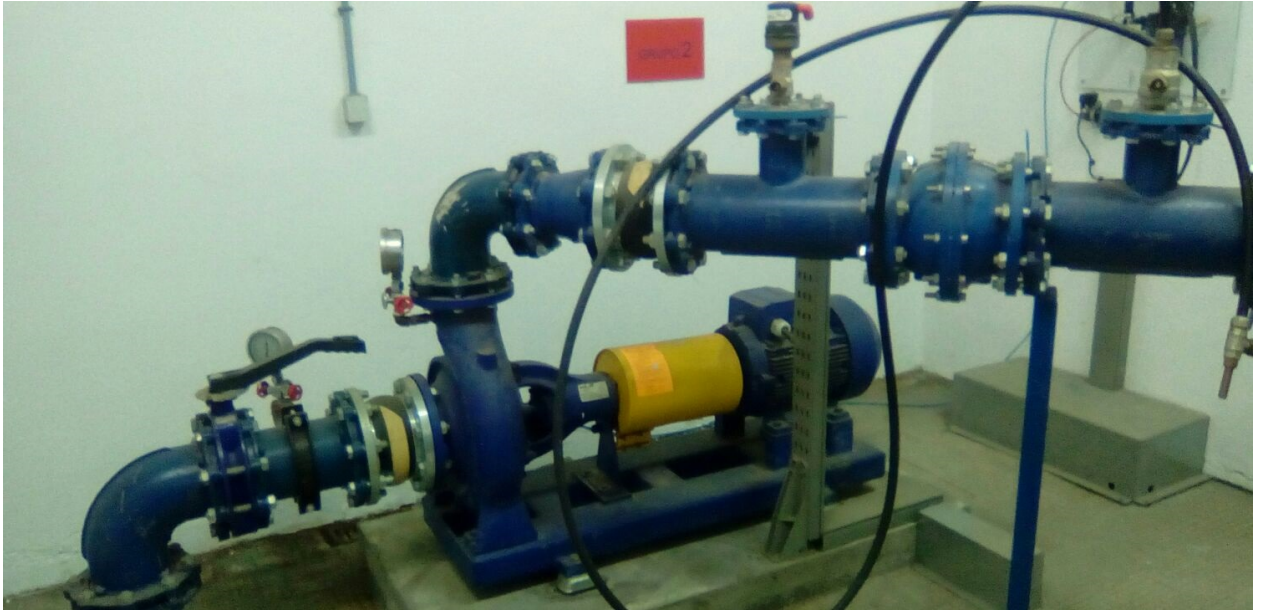
Conjunto de dos bombas de 126kW por unidad, en una estación de bombeo alejada de los depósitos.
