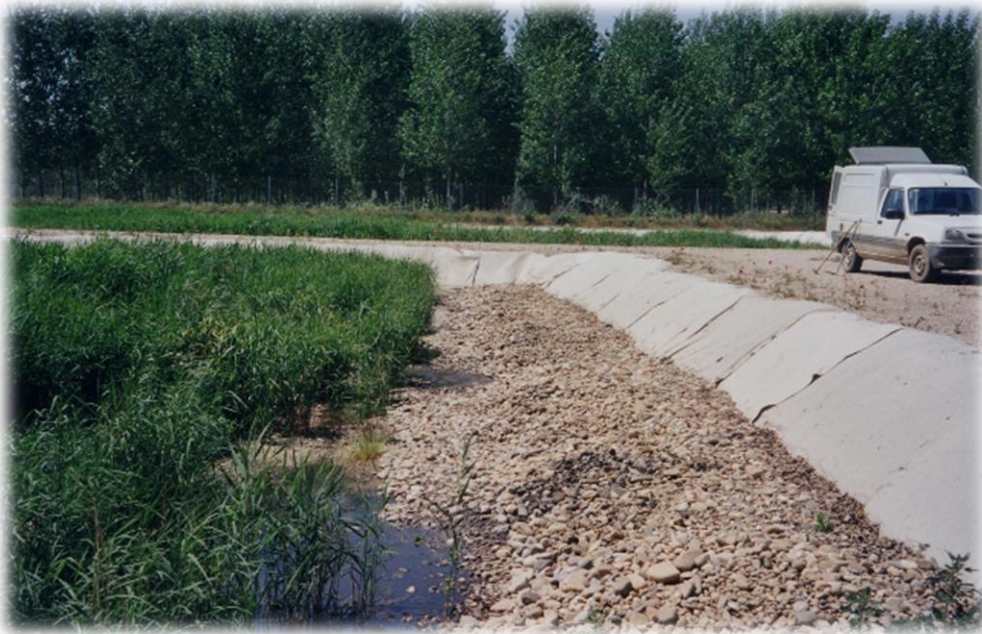
Figura 58. Franja de material granular de gran tamaño en la zona de entrada de un humedal de flujo subsuperficial horizontal. Fuente: Depuración con humedales construidos (García y Corzo, 2008)
