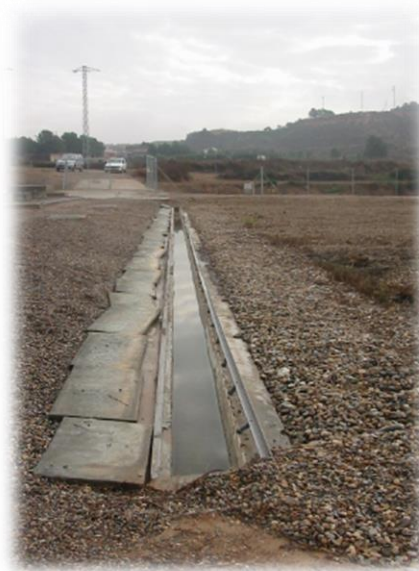
Figura 57. Canal de vertido en un humedal de flujo horizontal. Fuente: Depuración con humedales construidos (García y Corzo, 2008)
