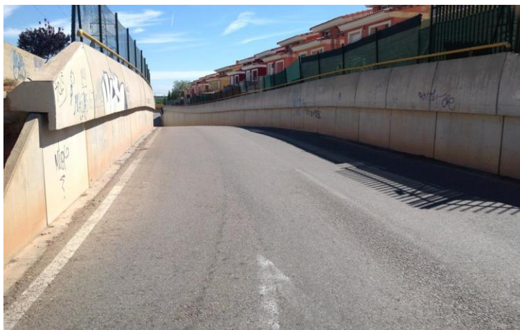
Figura 23. Imagen del túnel que comunica Masies con San Isidro y por el cual pasa el colector D 800 mm que vierte al barranco del Carraixet. Fuente: Trabajo de Fin de Grado (TFG) de Juan José Verdú Macián
