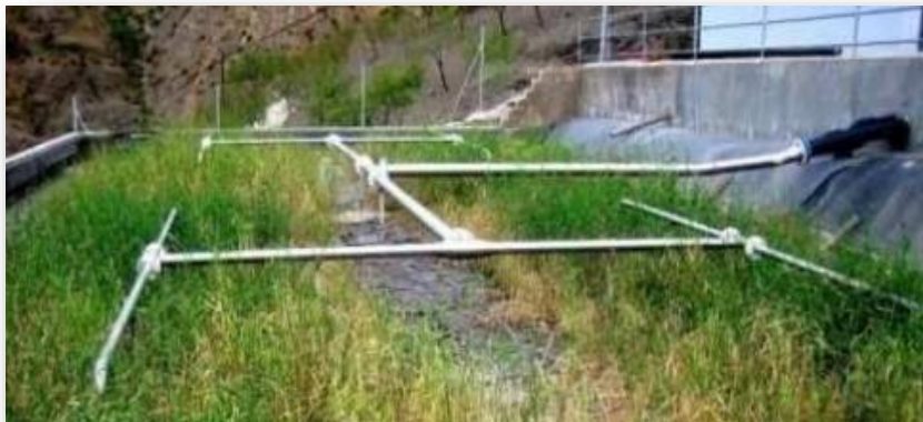
Figura 68. Tuberías de distribución de las aguas residuales sobre el lecho de pretratamiento del sistema Francés, Albondón, España. Fuente: Agencia de Cooperación Internacional de Alemania, GIZ. Programa de Saneamiento Sostenible ECOSAN (foto T. Burkard, AKUT, 2007).
