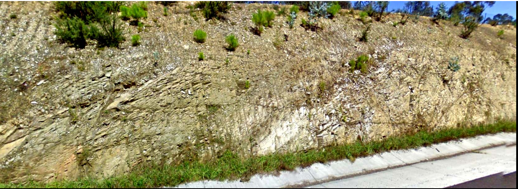
Talud de Autovía del Cantábrico, en las pizarras del Cámbrico del SW de La Magdalena, NE del Alto de La Coroa, SW Hoja de Ribadeo.
