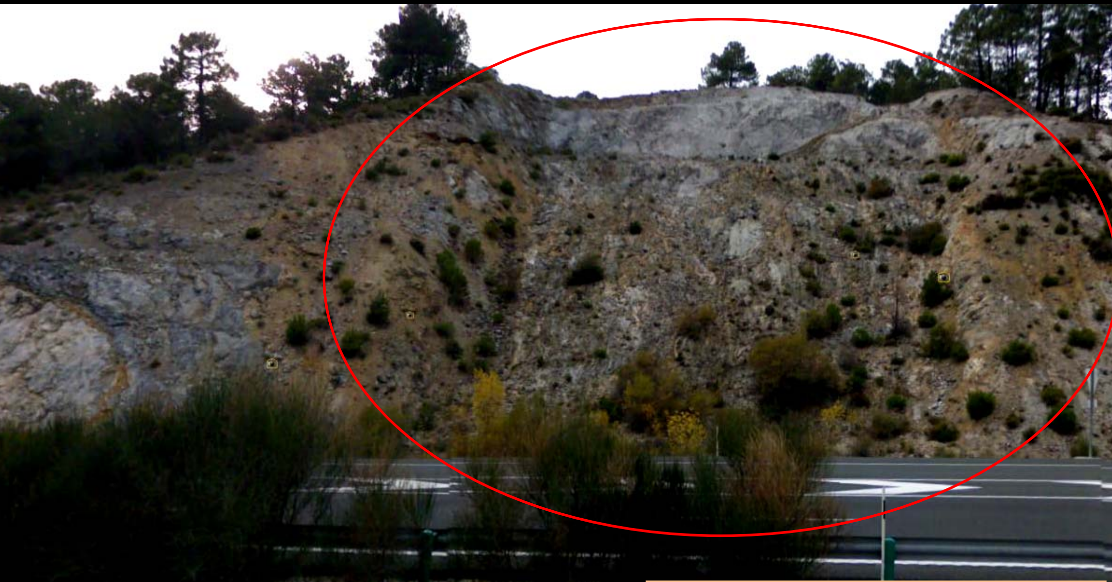
Inestabilidad en la ladera en las dolomías y calizas: mármoles. Manto de La Alpujarra. Triásico. Autovía. N de Huetor-Santillán. SW Hoja de La Peza
