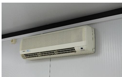
Figura 20. Detalle de uno de los sistemas de aire acondicionado existentes en la sala donde se encuentra la obra 'Valencianos a volar'.
