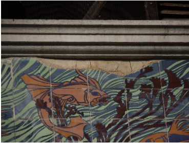
Imagen 19. Fractura y desprendimiento de la azulejería. IMAGEN PROPIA
