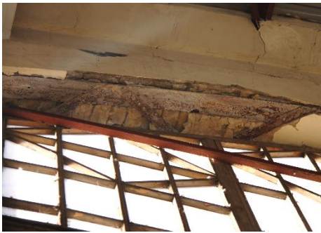
Imagen 14. Desprendimiento del revestimiento del muro a través del cual se ve la estructura interna del edificio. IMAGEN PROPIA
