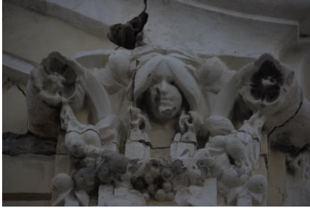
Imagen 16. Capitel fracturado por múltiples grietas. IMAGEN PROPIA
