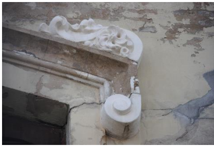
Imagen 17. Fachada atacada por las humedades y eflorescencias producto de las filtraciones. IMAGEN PROPIA
