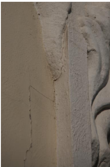
Imagen 15. Fisura producida en la fachada del tinglado nº2. IMAGEN PROPIA
