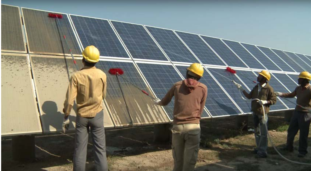
Ilustración 96. Operarios limpiando la suciedad de paneles fotovoltaicos. Fuente: Mithapur 17MW Solar Plant (Youtube).
