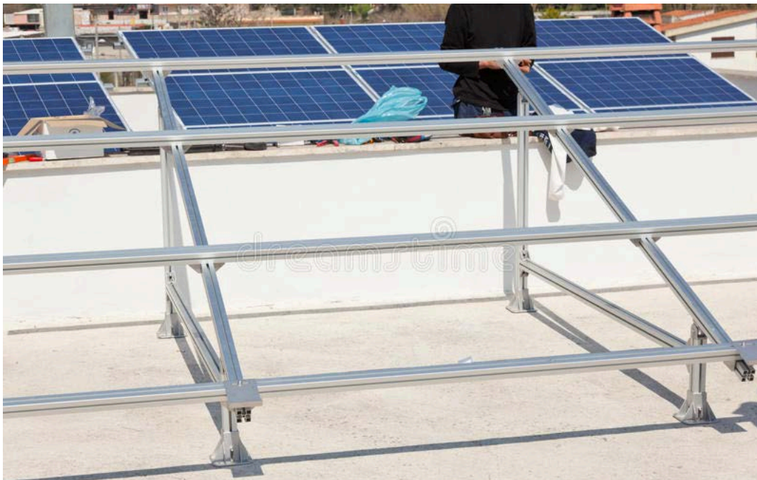
Ilustración 59. Estructura fija para paneles solares. Fuente: dreamstime.com
