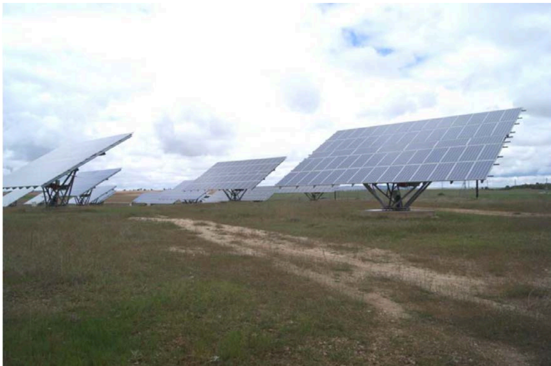
Ilustración 65. Central fotovoltaica de seguimiento en El Hito. Fuente: Juan Ángel Saiz
