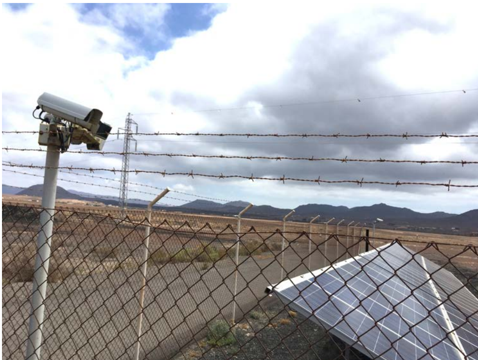
Ilustración 97. Sistema de CCTV en una explotación fotovoltaica en Fuerteventura. Elaboración propia.
