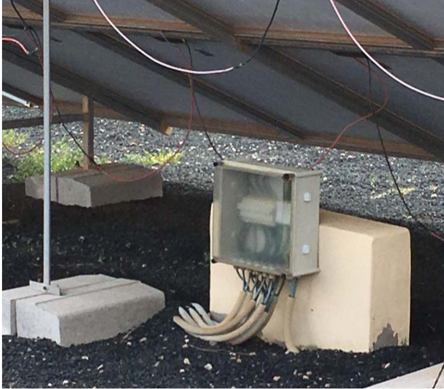
Ilustración 75. Ejemplo de caja de conexiones de instalación fotovoltaica. Fotografía propia.
