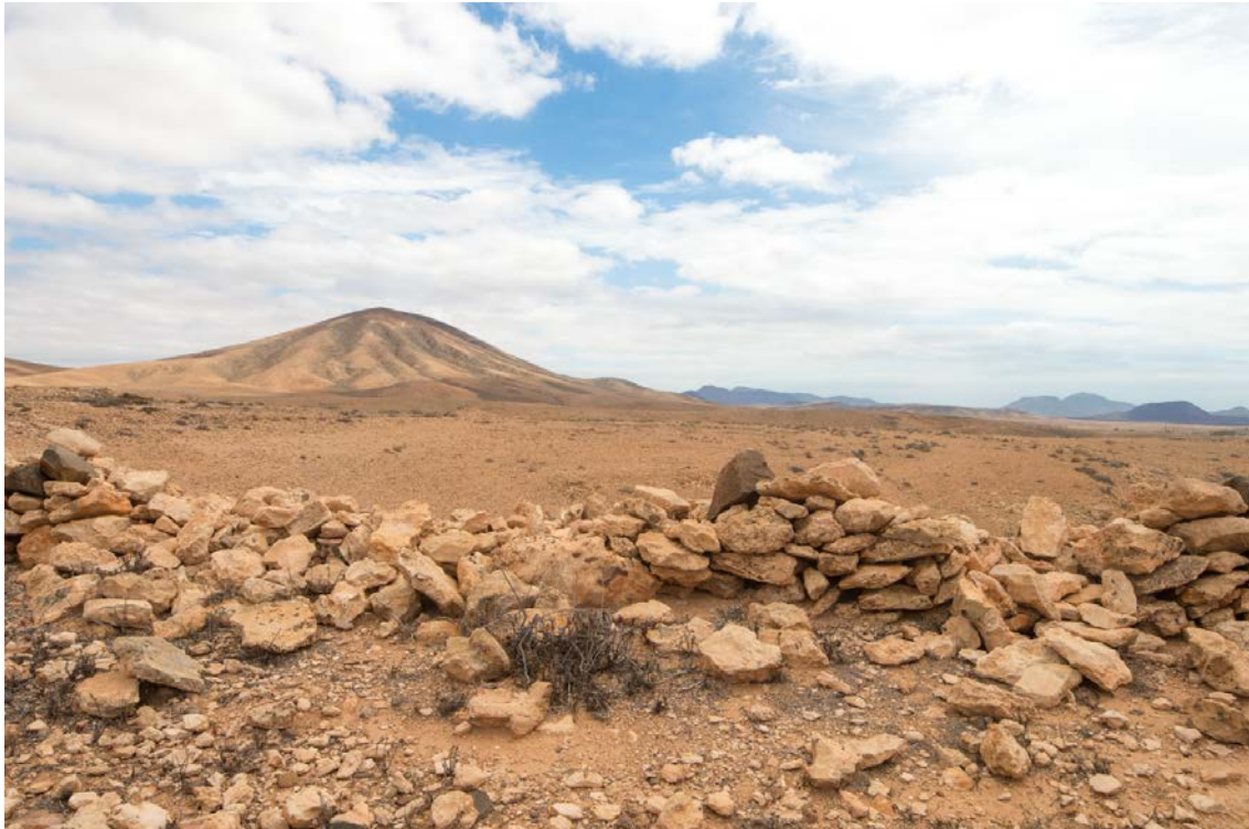
Ilustración 29. Muro de piedra parcialmente derruido en las proximidades de la zona. Montaña de Tamasite al fondo. Elaboración propia
