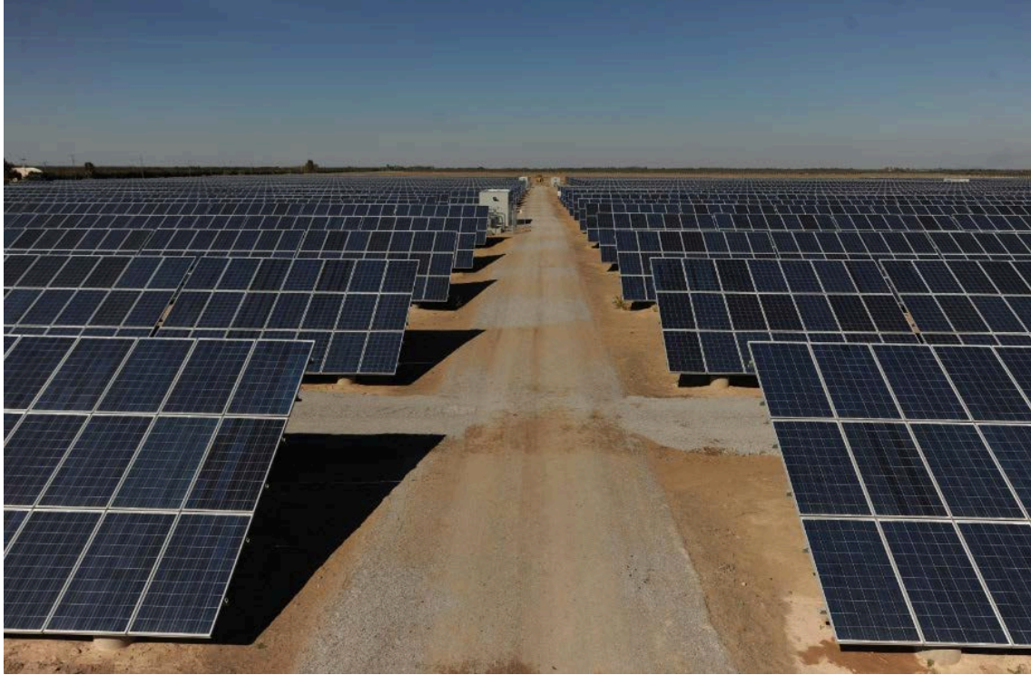
Ilustración 72. Configuración de paneles muy similar a la que implantaremos en nuestra central. Fuente: energiaestrategica.com
