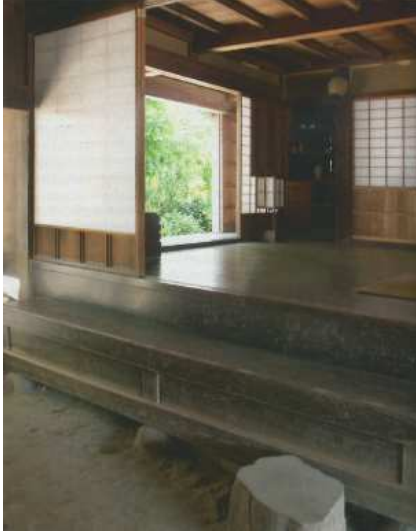
Fig. 41 Pavimento de madera visto con acabado pulido y liso en el umbral de acceso.
