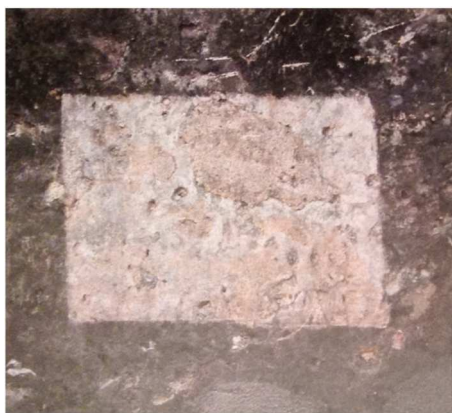
FIGURA 59: Muestra de limpieza de la fachada norte de un edificio afectado por líquenes. (F. Vegas y C. Mileto. 2014)
