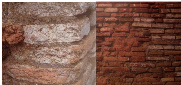
FIGURA 58: Eflorescencia. (F. Vegas y C. Mileto. 2014)
