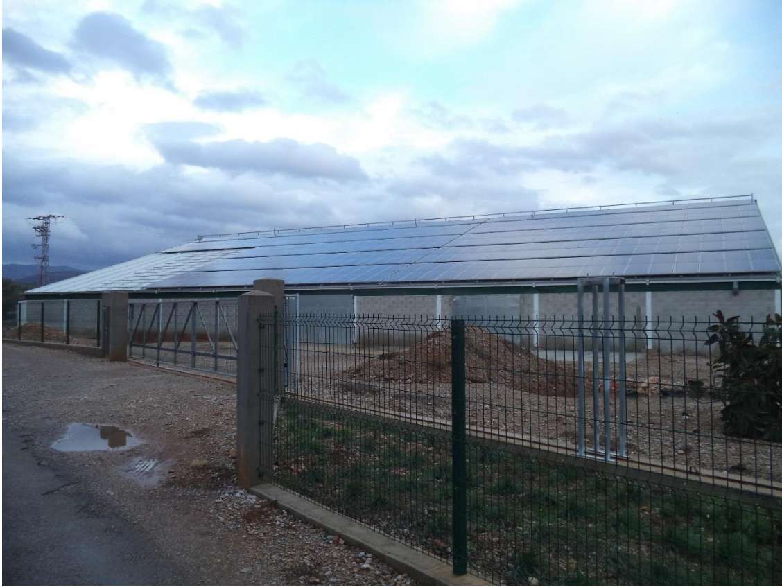
Figura 106: Almacén con la instalación fotovoltaica
