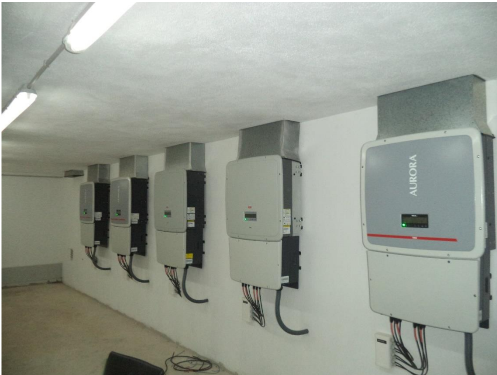
Figura 107: Inversores de la instalación fotovoltaica
