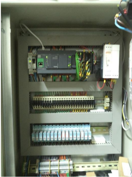
Figura 108: Autómata TM241 instalado en la explotación
