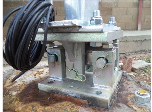
Figura 112: Células de carga instaladas en los silos
