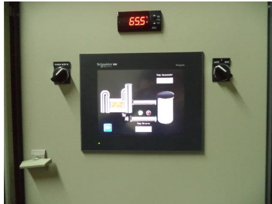
Figura 109: Panel HMI instalado en la explotación
