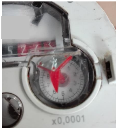
Ilustración 84. Aguja del medidor de litros rota del contador con ID 87
