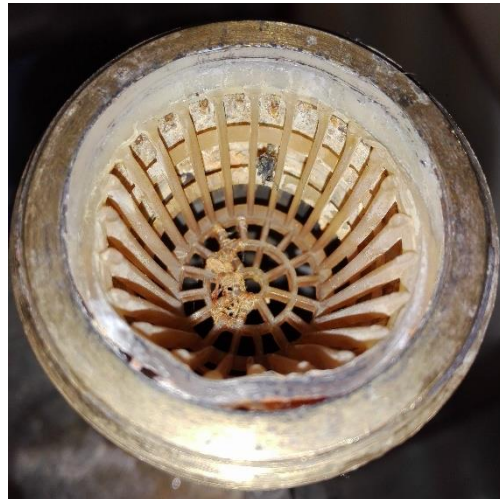
Ilustración 61. Estado del filtro del contador con ID 33
