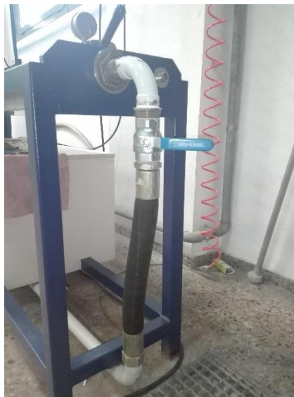
Ilustración 22. Válvula de seccionamiento a la entrada del banco de ensayo
