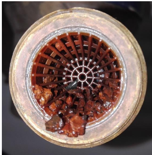
Ilustración 51. Estado del filtro del contador con ID 27
