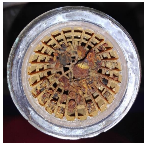
Ilustración 68. Estado del filtro del contador con ID 49
