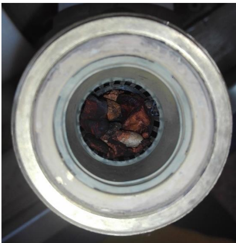
Ilustración 80. Estado del filtro del contador con ID 73
