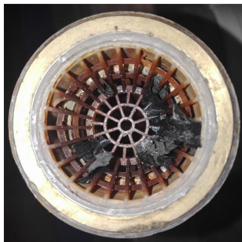
Ilustración 64. Estado del filtro del contador con ID 36
