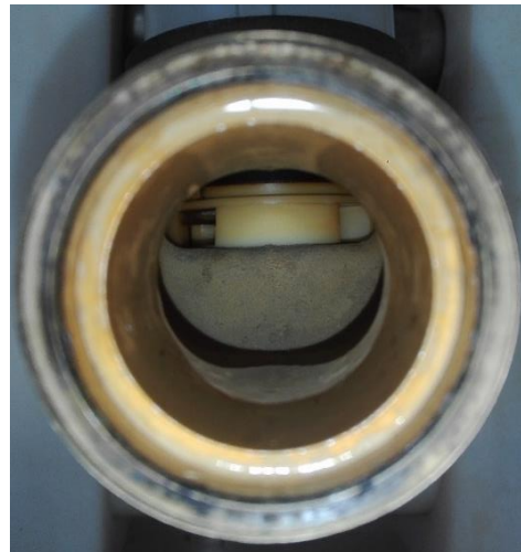
Ilustración 81. Estado del interior del contador con ID 73
