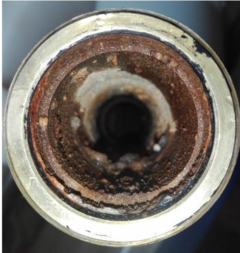
Ilustración 66. Estado del interior del contador con ID 42
