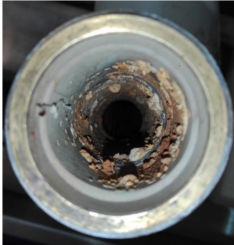
Ilustración 69. Estado del interior del contador con ID 55
