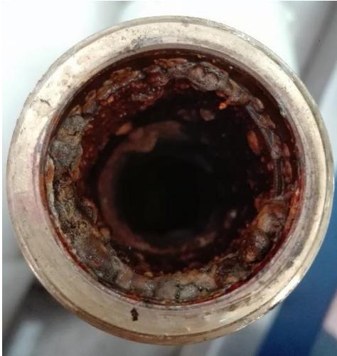
Ilustración 60. Estado del interior del contador con ID 32
