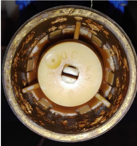
Ilustración 73. Estado de la salida del contador con ID 62
