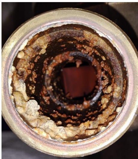
Ilustración 88. Estado del interior del contador con ID 106
