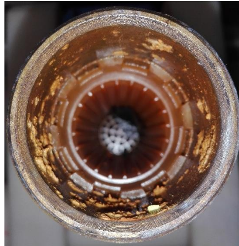
Ilustración 72. Estado del filtro del contador con ID 62
