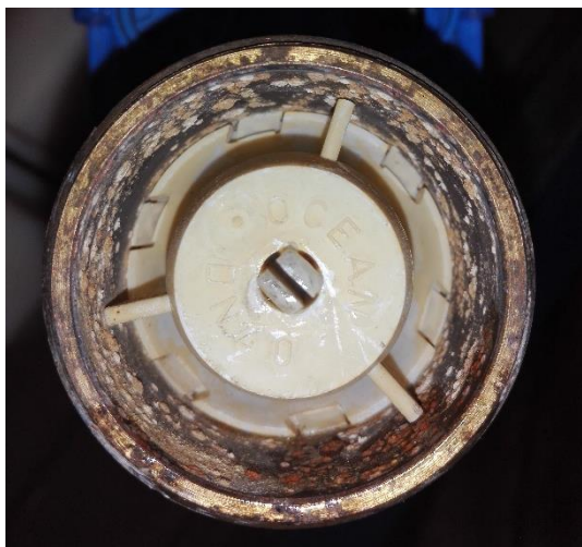
Ilustración 77. Estado de la salida del contador con ID 63
