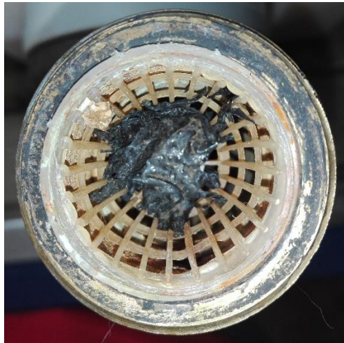
Ilustración 65. Estado del filtro del contador con ID 42
