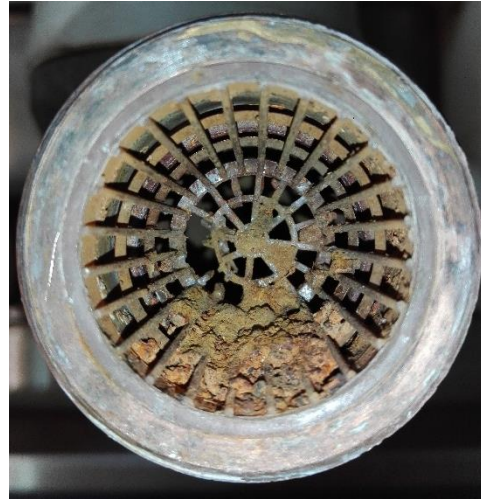
Ilustración 70. Estado del filtro del contador con ID 55
