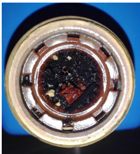
Ilustración 45. Estado del filtro del contador con ID 7
