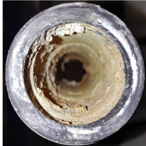
Ilustración 59. Estado del interior del contador con ID 38
