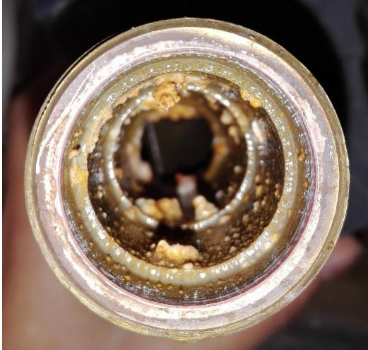
Ilustración 52. Estado del interior del contador con ID 24
