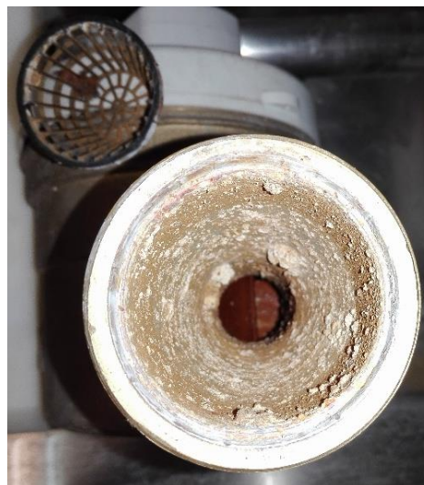
Ilustración 87. Estado del interior del contador con ID 105 retirando su filtro
