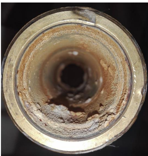
Ilustración 63. Estado del interior del contador con ID 36
