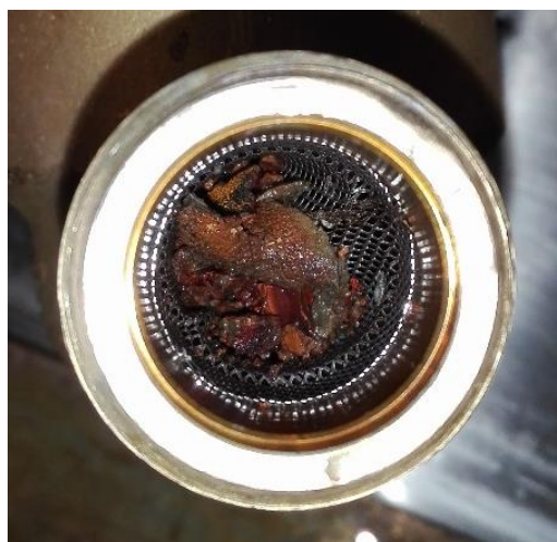
Ilustración 55. Estado del interior del contador con ID 28
