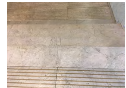
IMAGEN 16. Falta de señalización contrastada en el borde de los escalones
