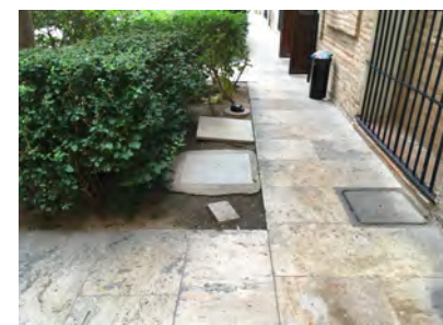
IMAGEN 16. Falta de bordillo perimetral a modo de zócalo que diferencie la zona ajardinada y evite tropiezos y caídas
