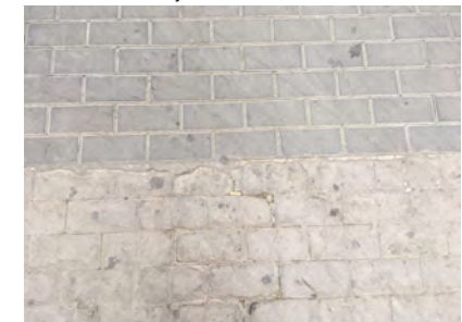
IMAGEN 7. Pavimento de adoquines sin resaltes y con buenas características generales en zonas de la calle Navellos
