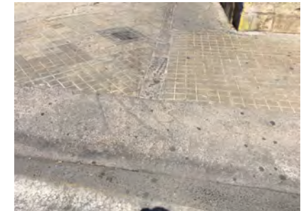
IMAGEN 11. Falta de señalización táctil
