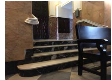
IMAGEN 20. Escalera que da acceso a la capilla de la Gloria. Observamos tabicas contrastadas
