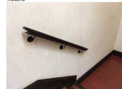
IMAGEN 24. Detalle del pasamanos con discontinuidad en los rellanos
