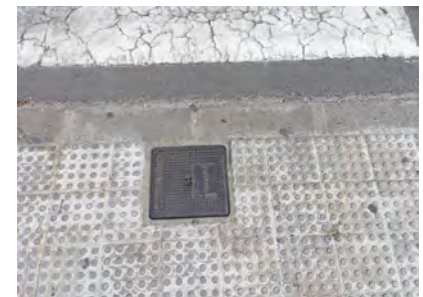
IMAGEN 14. Tapas de registro invaden itinerarios peatonales accesibles y paso de peatones
