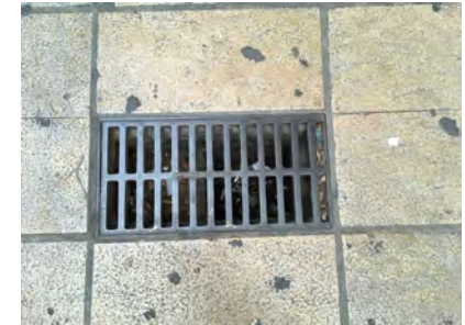
IMAGEN 5. Tapa de registro con abertura de los huecos de rejilla de 0,03m
