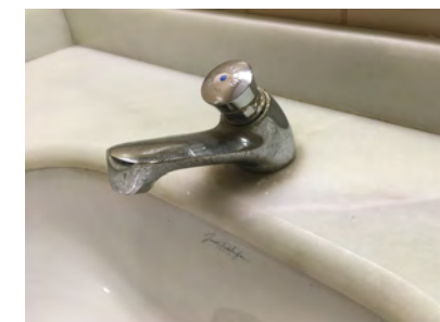
IMAGEN 46. Detalle de la grifería de difícil accionamiento
