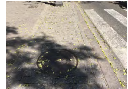
IMAGEN 6. Inexistencia de señalización táctil indicadora
