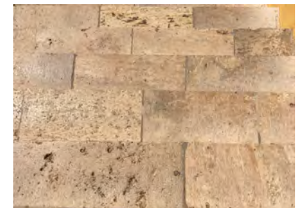
IMAGEN 19. Falta de contraste en el borde de los escalones dificultando su identificación
