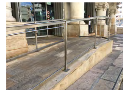
IMAGEN 28. Debido a la longitud del tramo la pendiente no cumple con la normativa ni con las tolerancias admisibles
