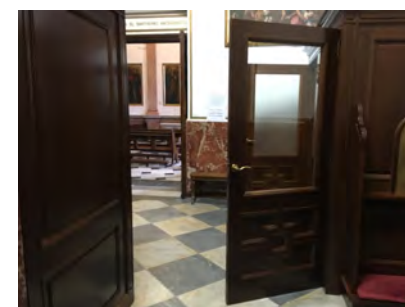
IMAGEN 14. La zona donde se ubican los confesionarios concentran abatimientos de puertas hacia el recorrido de circulación
