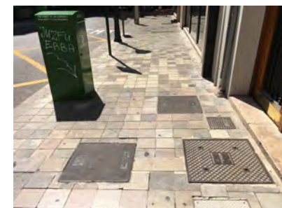
IMAGEN 13. Tapas de rejistro invadiendo itinerario peatonal en calle Marqués de Dos Aguas
