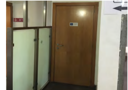
IMAGEN 43. Acceso al aseo adaptado sin espacio de maniobra suficiente
