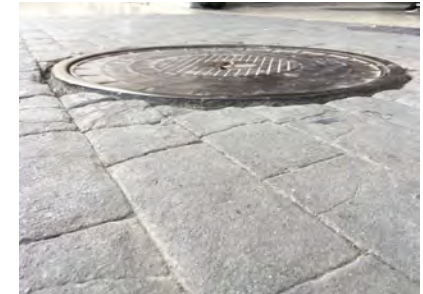
IMAGEN 9. Tapas de registro con falta de enrasamiento
