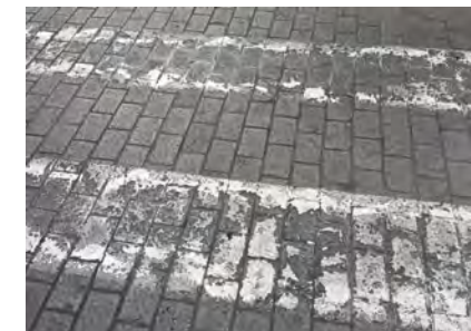
IMAGEN 6. Deterioro de la pintura señalizadora antideslizante
