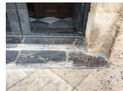
IMAGEN 9. Detalle del desgaste sufrido en los escalones
