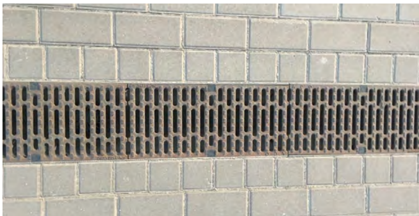
Fig. 29 Ejemplo de rejilla de abertura adecuada y enrasada (Fuente: El autor)
