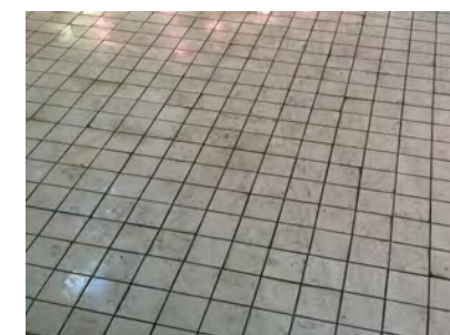
IMAGEN 32. El pavimento debido al uso del edificio puede estar resbaladizo en zonas como la de pescadería
