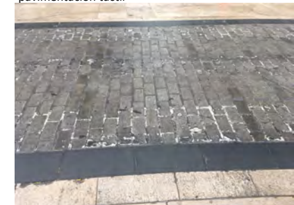
IMAGEN 5. Total falta de mantenimiento en la pintura de señalización
