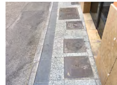
IMAGEN 12. Acera de reducidas dimensiones llena de tapas de rejistro en calle Venerables
