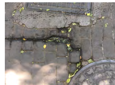
IMAGEN 16. La falta de junta entre los adoquines genera resaltes
