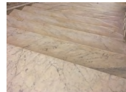
IMAGEN 19. Detalle de la dificultad para identificar los escalones al no haber bandas contrastadas
