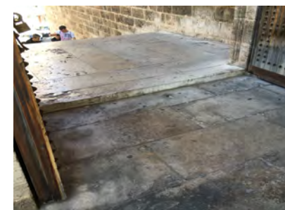
IMAGEN 18. Escalón aislado sin señalizar
