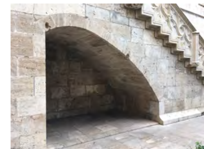
IMAGEN 20. Espacio bajo escalera no protegido de altura inferior a 2,10 metros
