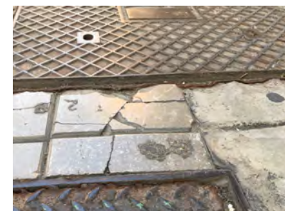
IMAGEN 7. Tapas de registro que necesitan ser enrasadas con el pavimento
