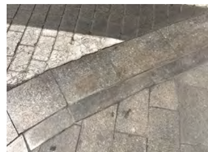
IMAGEN 11. Vado enrasado con la calzada pero ausencia de la señalización táctil
