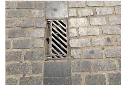
IMAGEN 16. Rejilla de desagüe con abertura mayor a la permitida por la normativa
