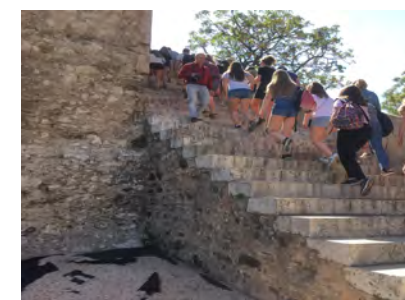
IMAGEN 19. Riesgo de caída por falta de protección lateral en la ESCALERA 2
