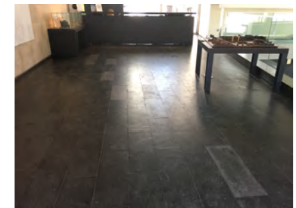
IMAGEN 3. Vista del itinerario desde el acceso a la recepción. Falta de señalización con pavimento táctil
