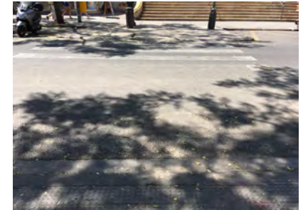
IMAGEN 7. Vista general del paso de peatones en la plaza del Mercado. Señalización con pintura totalmente deteriorada
