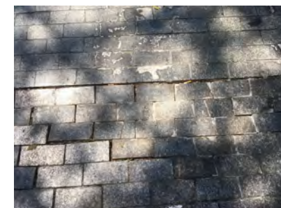
IMAGEN 7. Pavimento de adoquines en mal estado en el cruce peatonal de la calle Ercilla
