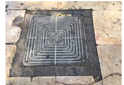
IMAGEN 9. Tapas de registro invaden itinerarios peatonales accesibles y no quedan enrasadas
