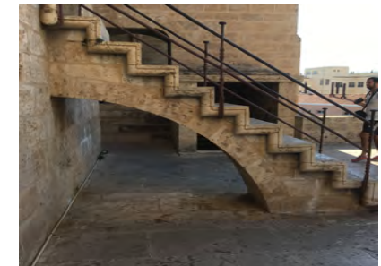
IMAGEN 21. Riesgo de golpearse bajo ESCALERA 5
