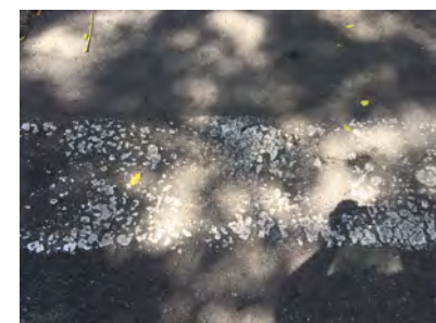
IMAGEN 6. Deterioro de la pintura de señalización
