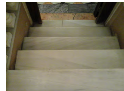
IMAGEN 20. Detalle de la falta de señalización en los peldaños
