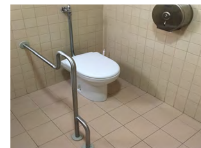
IMAGEN 46. Vista del inodoro con una sola barra fija que dificulta la transferencia
