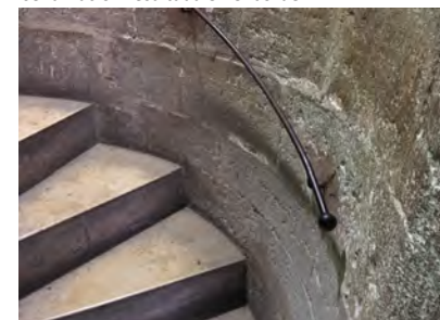
IMAGEN 24. Detalle del pasamanos existente y falta de contraste de la tabica
