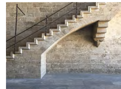
IMAGEN 22. Peligro de golpearse bajo ESCALERA 3
