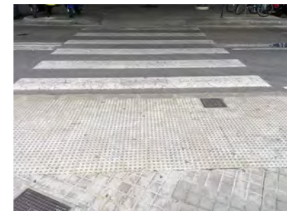
IMAGEN 7. Vista general del paso de peatones con señalización táctil en la longitud del vado
