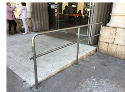
IMAGEN 22. Rampa de acceso DERECHA 1. Falta de señalización y zócalo
