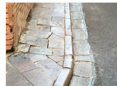
IMAGEN 15. Pavimento suelto y deteriorado en la calle En Colom
