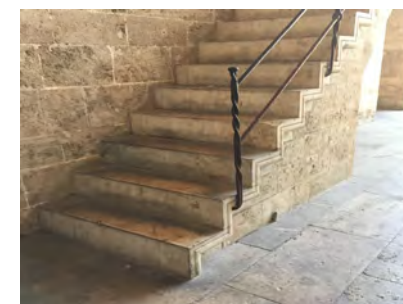
IMAGEN 23. Señalización inexistente en inicio y fin de la escalera ni en peldaños
