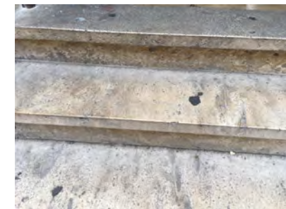
IMAGEN 3. Detalle de los escalones del acceso. Sin señalización contrastada y con bocel
