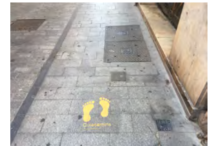
IMAGEN 17. Tapas de registro invadiendo el itinerario peatonal accesible
