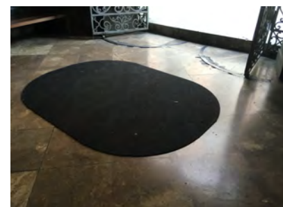
IMAGEN 5. Felpudo en la entrada del edificio no encastrado con el pavimento
