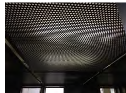
IMAGEN 31. La iluminación del ascensor se ve desfavorecida por la rejilla protectora
