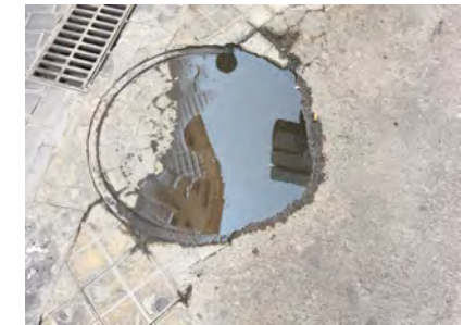
IMAGEN 18. Los resaltes y ejecución deficiente de pendientes genera acumulación de agua en las aceras
