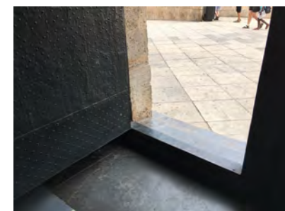
IMAGEN 10. Vista desde el interior de los peldaños de acceso con el obstáculo que supone la estructura del portón
