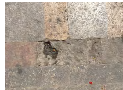
IMAGEN 15. A lo largo del recorrido encontramos zonas de pavimento deterioradas
