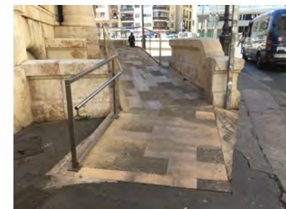
IMAGEN 27. Inicio de la rampa DERECHA 2 con carencia de señalización y pasamanos
