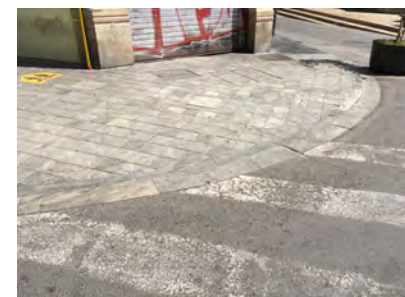
IMAGEN 8. Falta de señalización táctil y deterioro de la pintura de señalización
