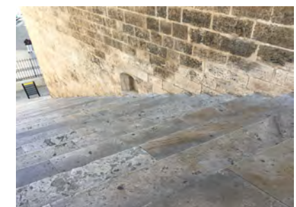
IMAGEN 16. ESCALERA 2 apreciamos la falta de bandas contrastadas en los peldaños y pasamanos
