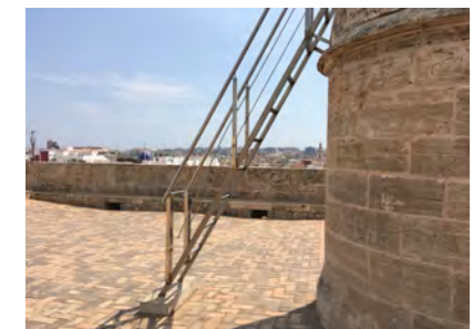
IMAGEN 31. Espacio bajo escalera con riesgo de golpearse
