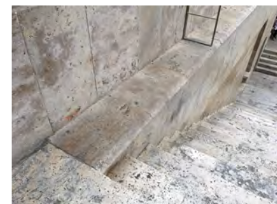
IMAGEN 19. Ausencia de pasamanos en uno de los laterales de la escalera
