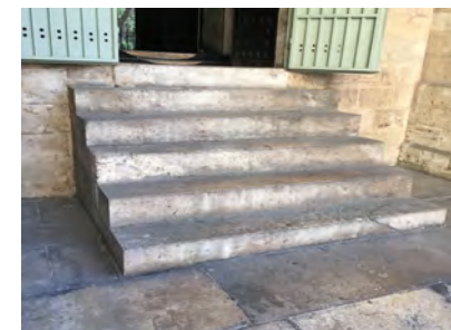
IMAGEN 4. Escalera 1 de acceso a la recepción sin pasamanos ni señalización contrastada
