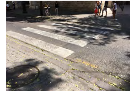
IMAGEN 4. Paso de peatones en la calle San Vicente Mártir. Falta de señalización táctil, vado y ausencia de advertencia necesaria para los vehículos
