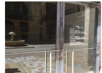
IMAGEN 5. Puerta de vidrio sin señalización de bandas contrastadas
