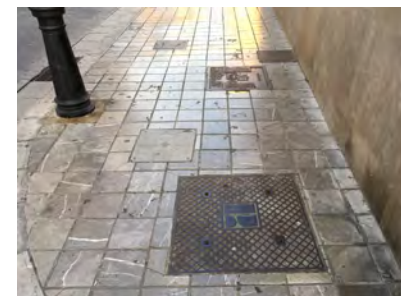
IMAGEN 6. Acumulación de tapas de registro en el itinerario peatonal accesible
