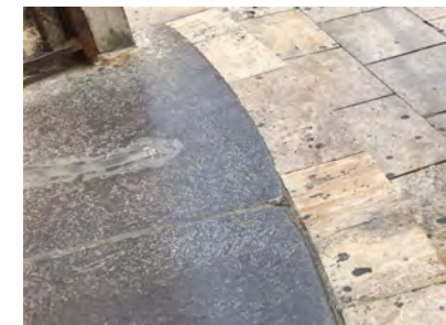
IMAGEN 3. Detalle de los escalones sin señalización contrastada en el borde
