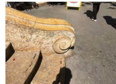
IMAGEN 4. Zócalo lateral sin pasamanos en los extremos de la escalera
