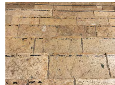
IMAGEN 3. Deficiente señalización de los peldaños de la escalera
