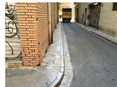
IMAGEN 1. Calle En Colom con paso de vehículos y aceras intransitables
