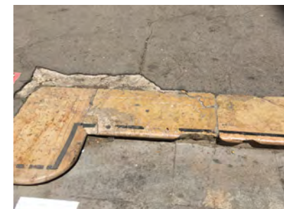
IMAGEN 20. Peldaño aislado previo a la escalera de acceso. Deterioro del material y la señalización
