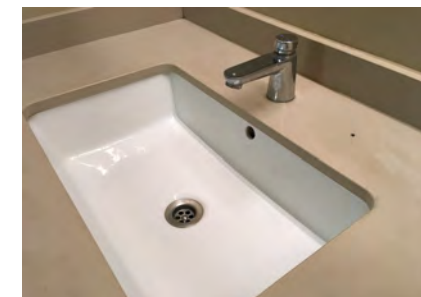
IMAGEN 26. Detalle de la grifería no accesible con apertura de presión
