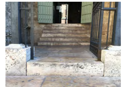
IMAGEN 3. Acceso principal a la recepción sin señalización en escalón
