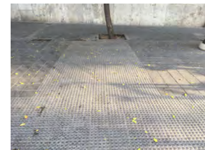
IMAGEN 9. El pavimento táctil no llega hasta línea de fachada y se encuentra con un árbol
