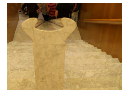
IMAGEN 18. Detalle del pasamanos central y falta de señalización contrastada en el borde de cada escalón
