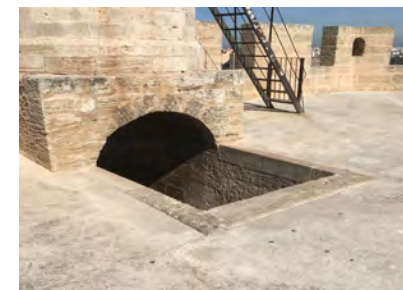
IMAGEN 28. Circulación por la planta Terraza con peligro de caída por ESCALERA 5
