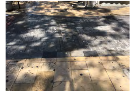
IMAGEN 4. Paso de peatones en la plaza del Mercado con la calle Ercilla. Falta de señalización táctil en ambos lados del vado
