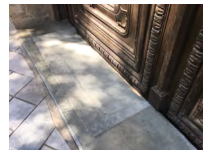
IMAGEN 3. Ámbito de la puerta, sin desnivel, de acceso de PSR por la calle Poeta Querol
