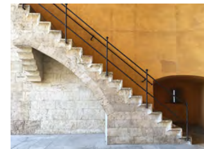
IMAGEN 23. Peligro de golpearse bajo ESCALERA 3
