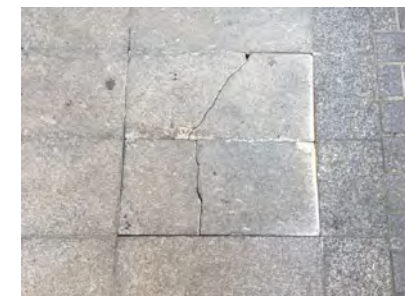
IMAGEN 10. Pavimento de zonas de calle Avellanas en mal estado
