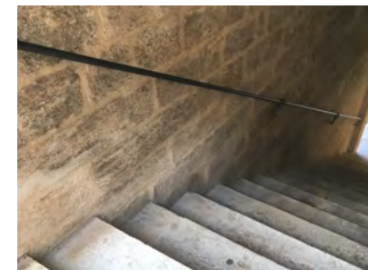
IMAGEN 24. Segundo tramo de la ESCALERA 3 con carencias en el pasamanos
