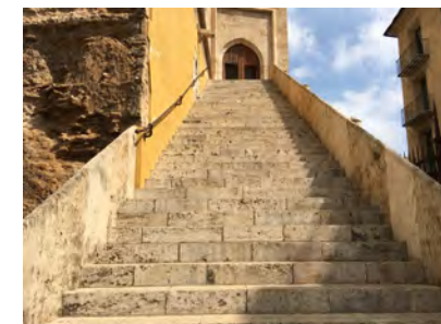
IMAGEN 15. ESCALERA 2 apreciando la falta de contraste entre huella y tabica
