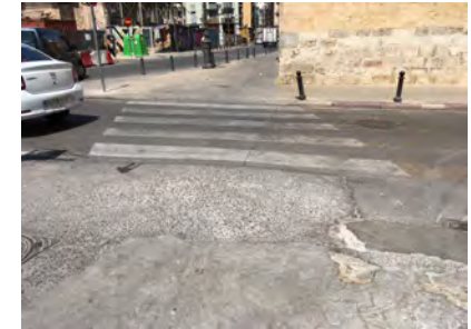
IMAGEN 10. Vista general del paso de peatones en la plaza Ciudad de Brujas. Pavimento deteriorado
