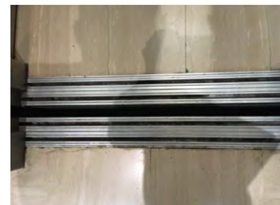
IMAGEN 29. Detalle de la abertura horizontal de la cabina del ascensor
