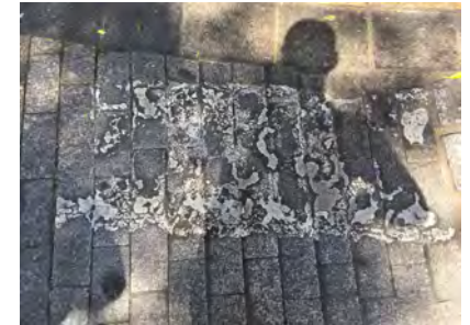
IMAGEN 5. Falta de mantenimiento de la pintura señalizadora
