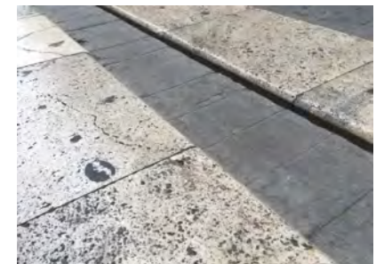
IMAGEN 11. El sistema de desagüe de la calle Navellos genera desniveles en el pavimento
