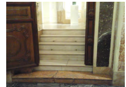
IMAGEN 19. Vista de la escalera que da acceso a la sala de exposiciones temporales 1
