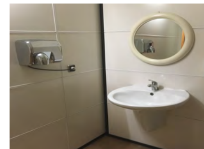
IMAGEN 19. El espejo se encuentra demasiado alto y no tiene inclinación
