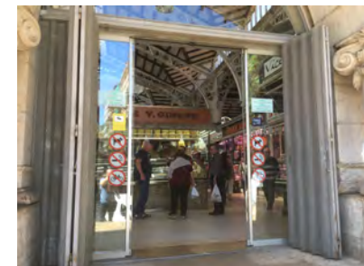
IMAGEN 5. Detalle de una de las 3 puertas automáticas de vidrio de acceso al Mercado
