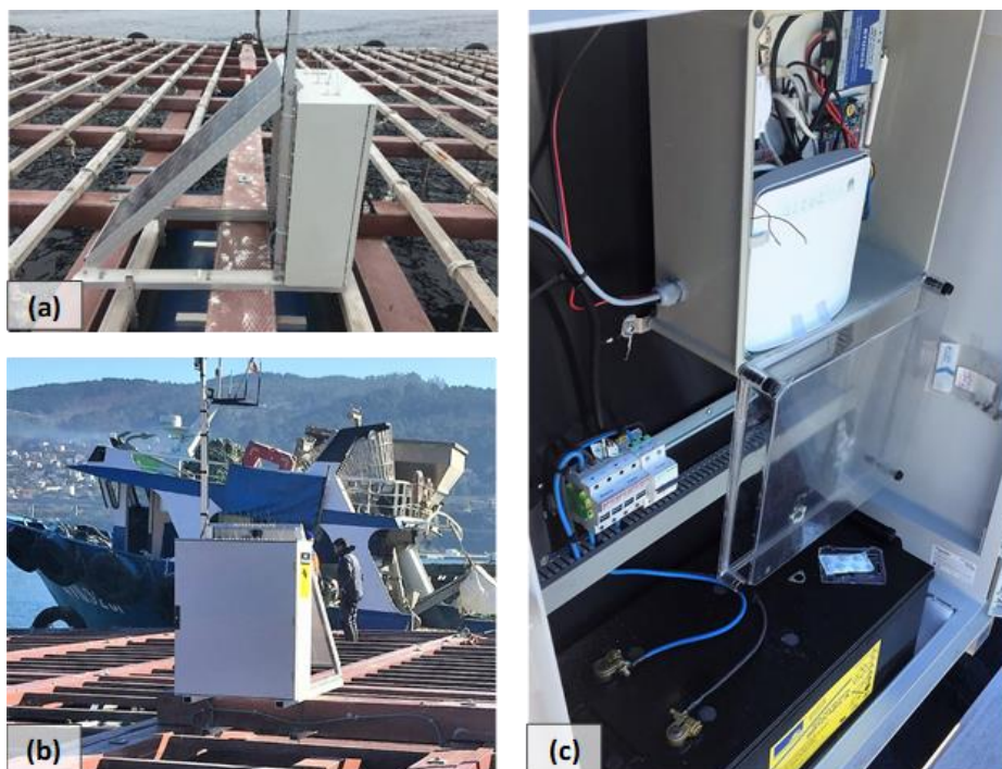
Figura 4.57. Sistema fotovoltaico instalado en zona accesible en la BFM (a) y la BFP (b). Los dispositivos de almacenamiento, regulación y control de este sistema de alimentación se encuentran dentro de un armario estanco junto a la RPi y el módem de conexión 4G (c).
