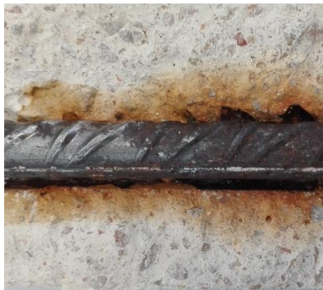
Figura 1.11. Armadura que presenta una zona de corrosión uniforme y otra zona no corroída. Fuente: propia
