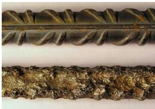
Figura 1.16. Armadura con una gran pérdida de sección consecuencia de la corrosión. 78
