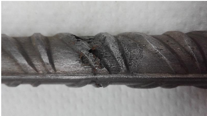
Figura 1.8. Armadura en la que tras limpiar los productos de corrosión adheridos se observa una picadura por ataque de cloruros. Fuente: propia
