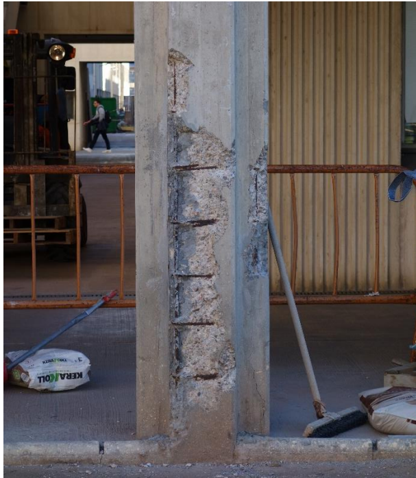
Figura 1.15. Pilar de hormigón armado donde la corrosión de las armaduras ha provocado el desprendimiento de parte de la capa de recubrimiento. Fuente: propia
