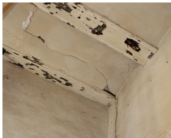
Figura 27. Grietas y fisuras
