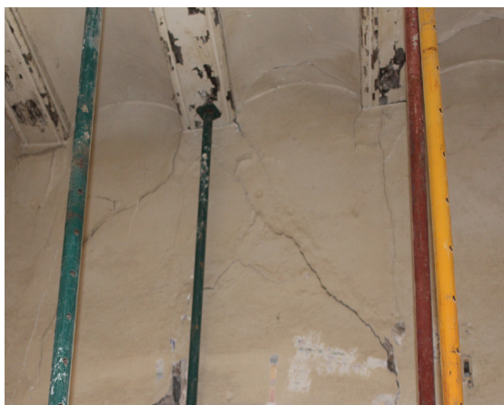
Figura 26. Grietas y fisuras muro sur.
