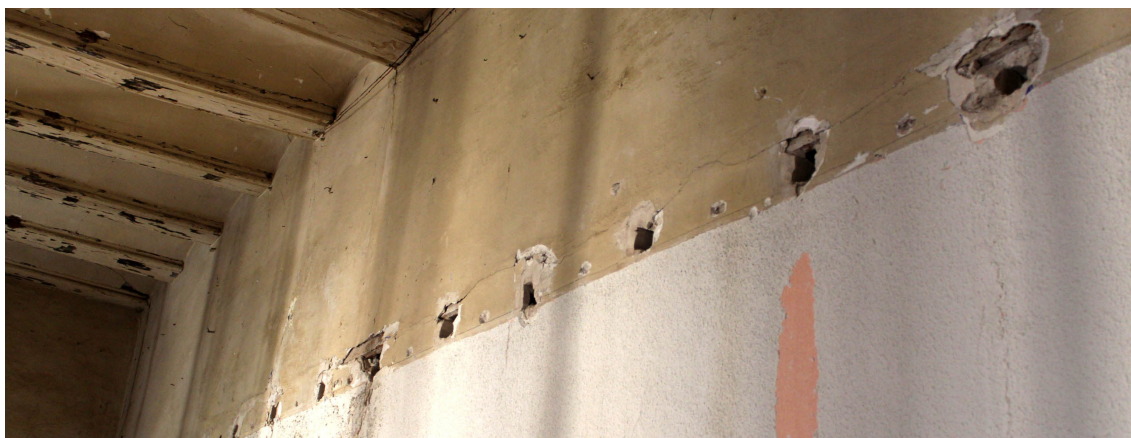
Figura 29. Lagunas originadas por la eliminación del sistema de vigas.
