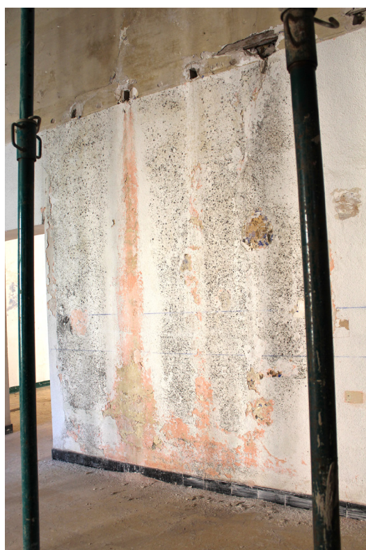
Figura 28. Filtración muro norte.
