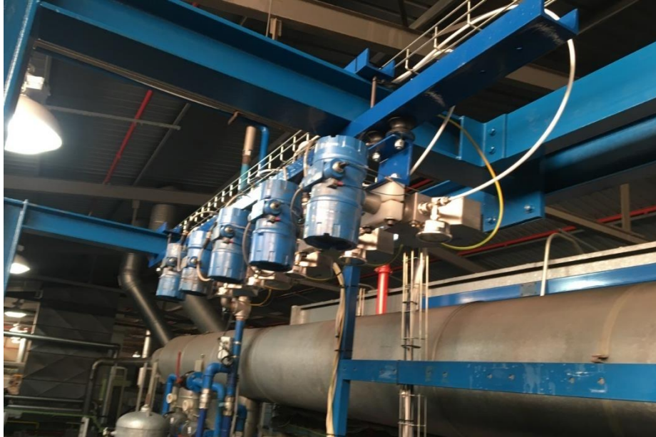
Fig. 40. Foto tras la modificación de la disposición de los caudalímetros acorde al manual de instalación del modelo.
