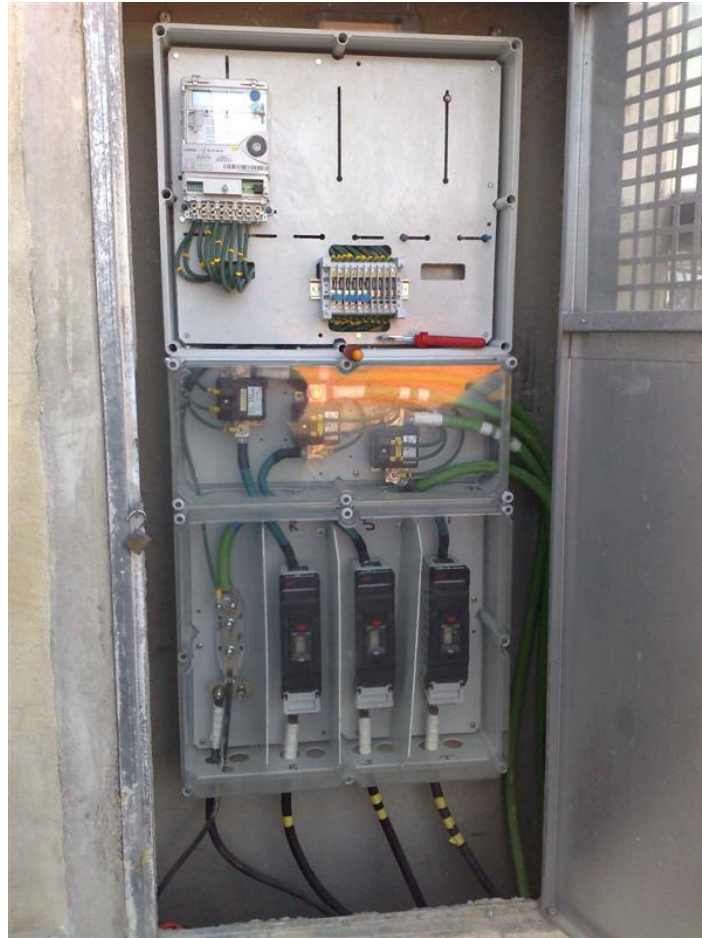
Ilustración 1: Caja general de protecciones con solera de hormigón
