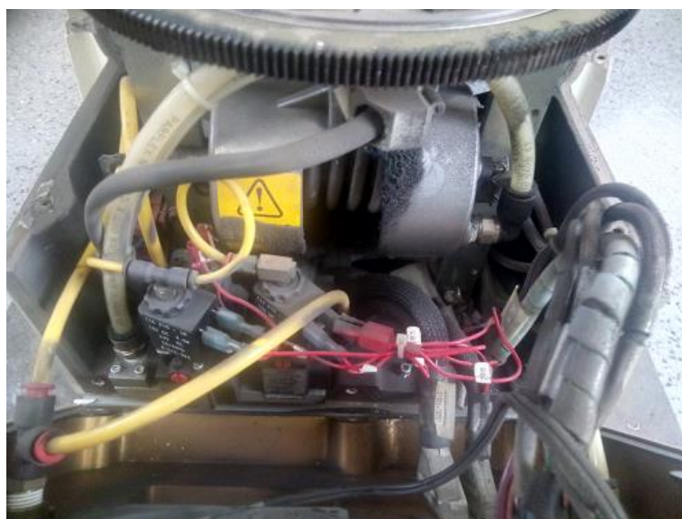
Figura 3.3.- Electroválvulas neumáticas de frenado de las articulaciones (Fuente: propia).
