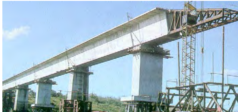
El puente sobre el río Caroní : primer puente de hormigón pretensado empujado (Venezuela, 1963. Vanos de 96 m, Leonhardt & Ändra)
