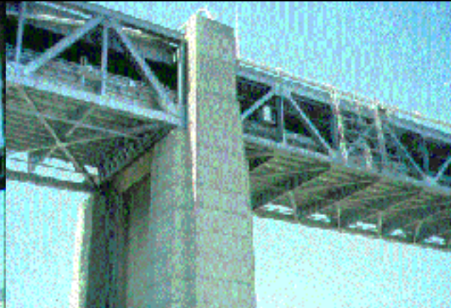
■Pila-estribo para apoyo de la viga de rigidez y del viaducto de acceso al Baybridge
