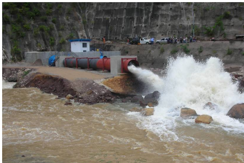
Figura 5.9. Estado actual de la descarga de emergencia.
