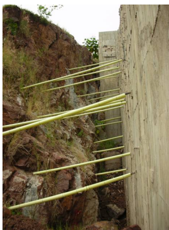
Figura 5.21. Contacto sin rellenar entre los muros y las laderas.
