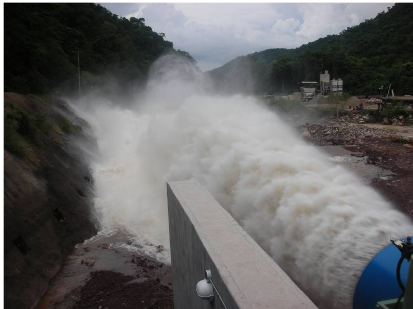
Figura 5.12. Apertura de la válvula de regulación.
