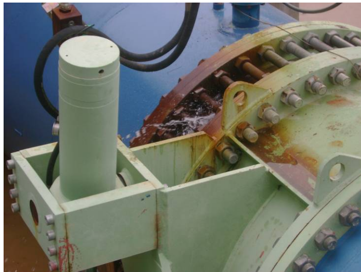
Figura 5.25. Fuga en la válvula de regulación
