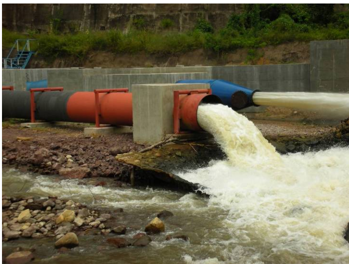
Figura 5.20. Descarga de Emergencia y Adicional.
