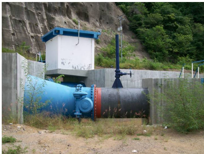
Figura 5.23. Descarga de emergencia
