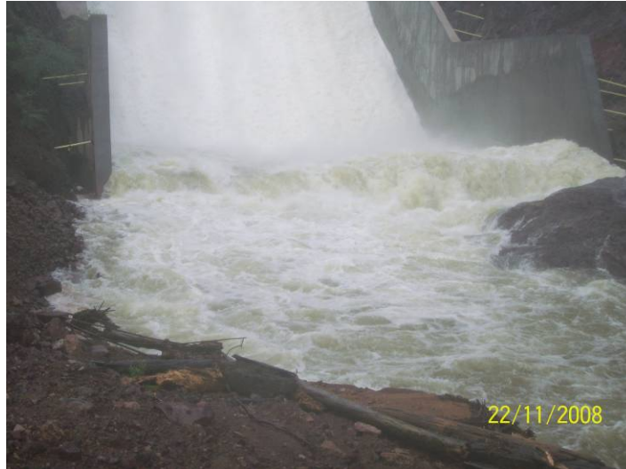
Figura 5.67. Erosión durante el alivio
