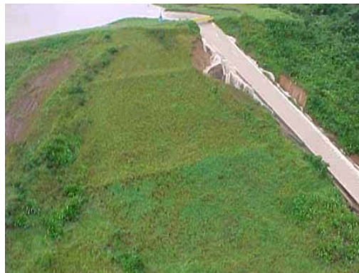
Figura 3.9. Inicio del desborde del canal rápido del aliviadero.
