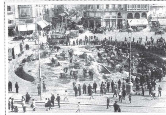
Las obras del nuevo Mercado de Flores que se levantará en la plaza de Emilio Castelar
