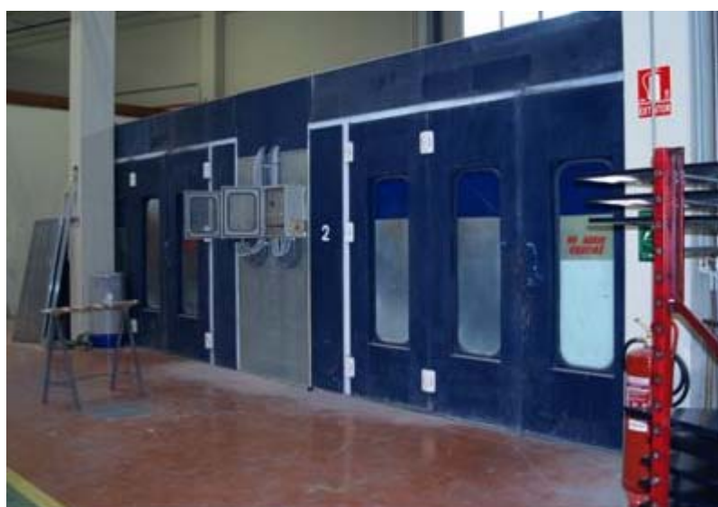
Figura 30: Detalle de la cabina de pintura
