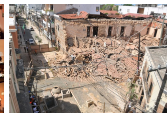
Colapso del Hotel Francés. Fuente - Listín Diario
