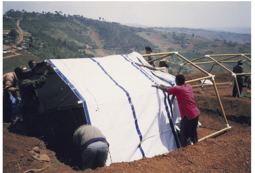
[Fig.29] Refugios de emergencia de papel UNHCR - Campo de refugiados Byumba , Ruanda, 1999
