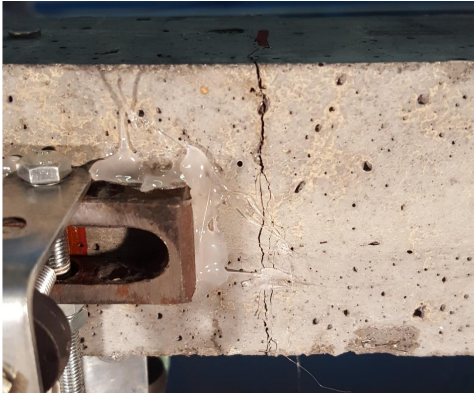
Fig 94.- Fisuras producidas en el ensayo realizado. (Fuente Propia)
