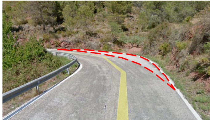
FIGURA 6. SOBREANCHO FORMADO POSTERIORMENTE A LA CARRETERA, P.K. 22+800. FUENTE: ELABORACIÓN PROPIA, 2018.
