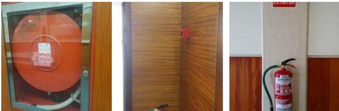
Ilustración 22. Elementos mantenidos en las instalaciones de Protección Contra Incendios.
