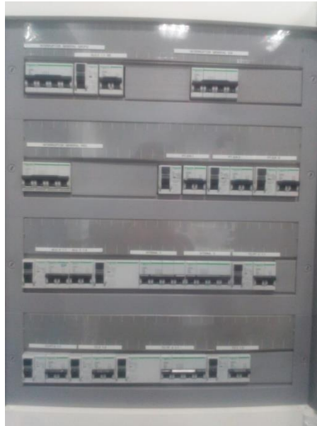
Ilustración 20. Cuadro eléctrico del edificio estudiado (ETSID).
