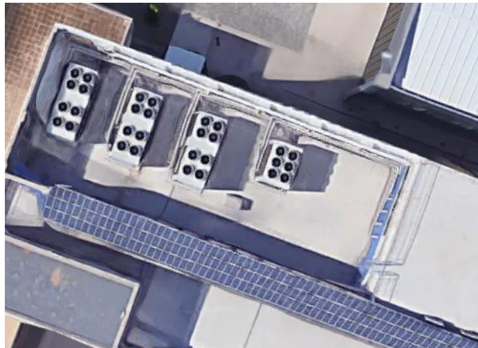
Ilustración 15. Vista aérea de máquinas de frío de la cubierta de la ETSID.
