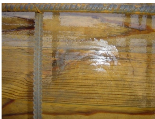
Figura 16 Incorrecta aplicación de desencofrante [21].
