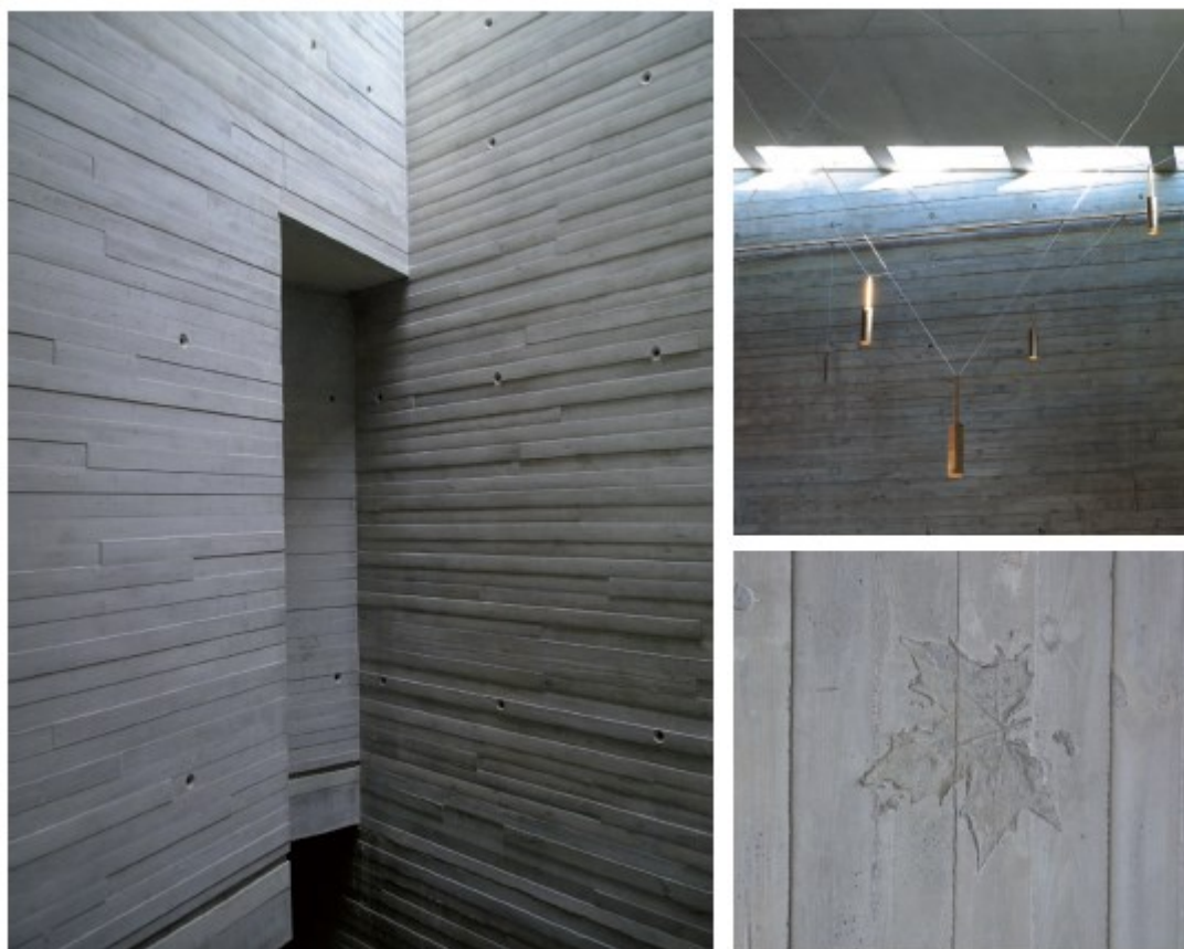
Figura 1 Acabados del hormigón visto [10].
