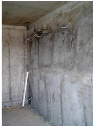
Figura 35 Deformaciones y manchas en el hormigón [13].
