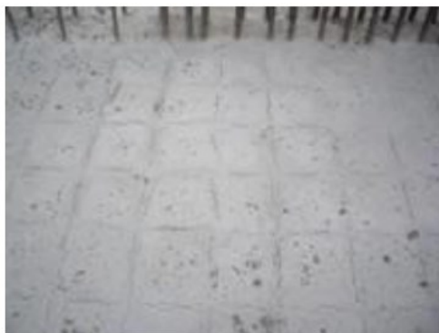
Figura 38 Fisuras por asentamiento [13].
