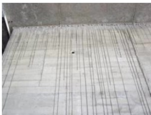
Figura 45 Pérdida de lechada[13]
