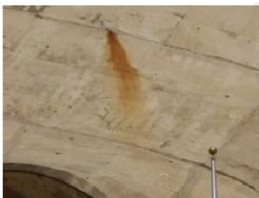
Figura 43 Manchas debido a la presencia de hierro o pirita en los áridos [13].
