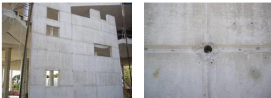
Figura 9 Oscurecimiento de la superficie de hormigones blancos [13].
