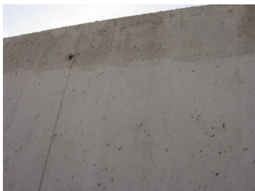
Figura 17 Manchas en hormigón gris por exceso de desencofrante [21].
