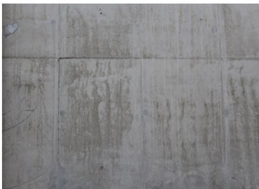
Figura 41 Manchas por amasado insuficiente [11].
