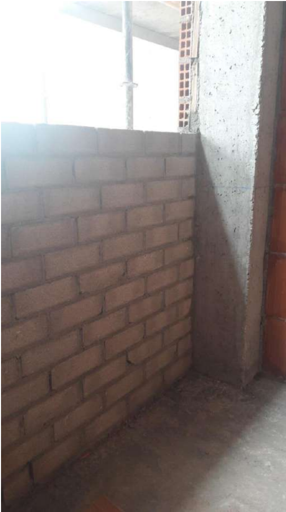
IMAGEN 31: Antepecho – terraza excesivamente alto
