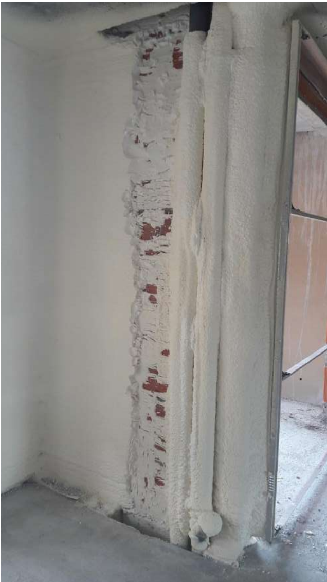
IMAGEN 46: Faltan conductos de ventilación
