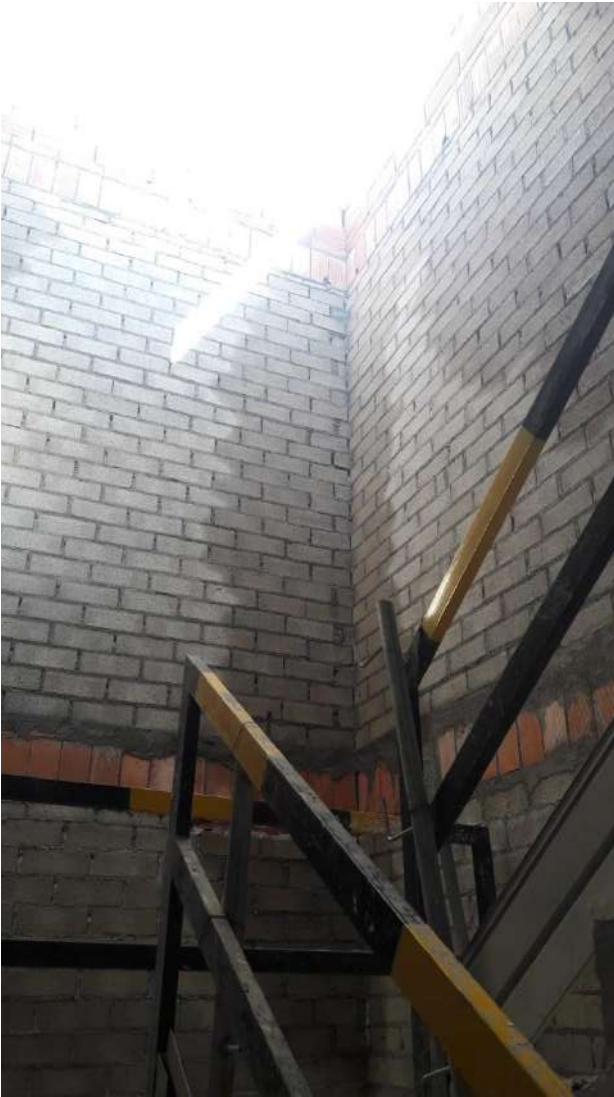
IMAGEN 80: Humedades debido a las fuertes lluvias.
