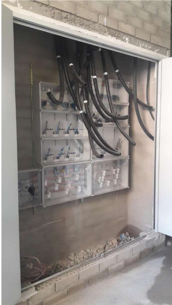
IMAGEN 82: Cuadro de instalaciones en la planta baja.
