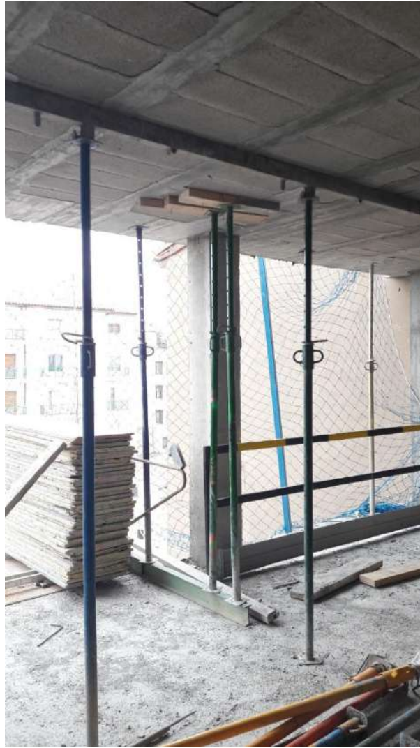
IMAGEN 9: Mal apuntalamiento de la plataforma de carga y descarga. Posible rotura de bovedilla
