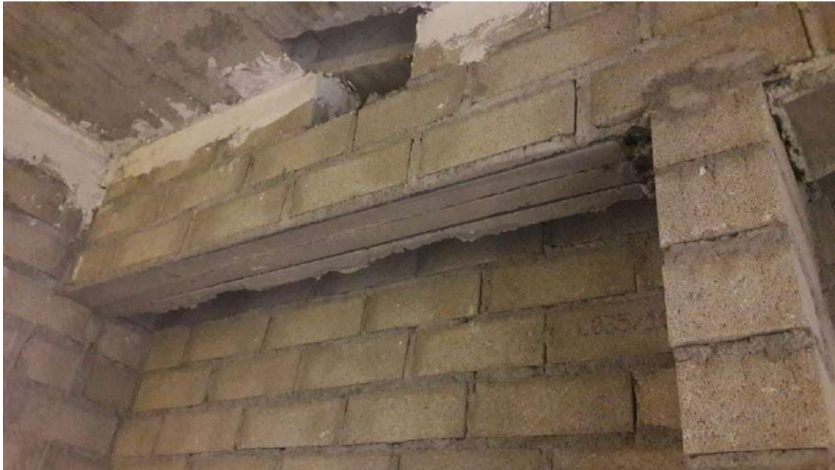
IMAGEN 36: Mal dimensionamiento del dintel y mala ejecución.
