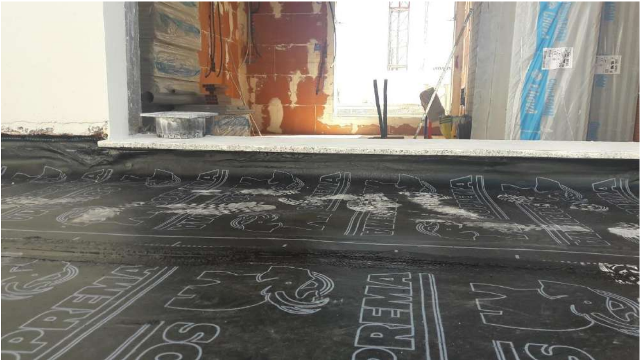
IMAGEN 103 b: Solape en la puerta de acceso
