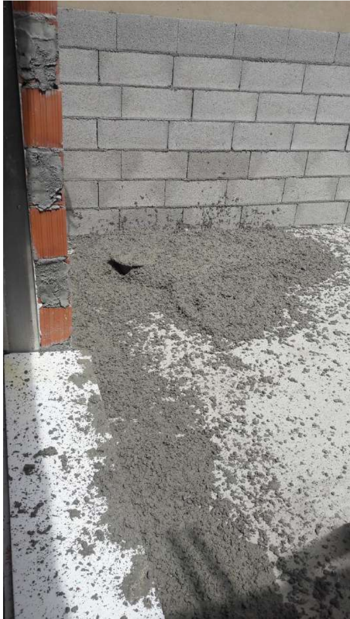
IMAGEN 61: Incidencia al volcarse la cuba llena de hormigón.
