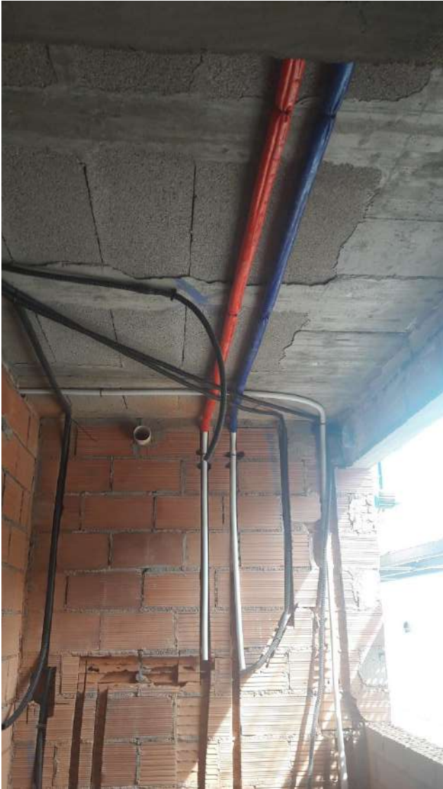
IMAGEN 86: Agua fría y caliente para la posterior caldera
