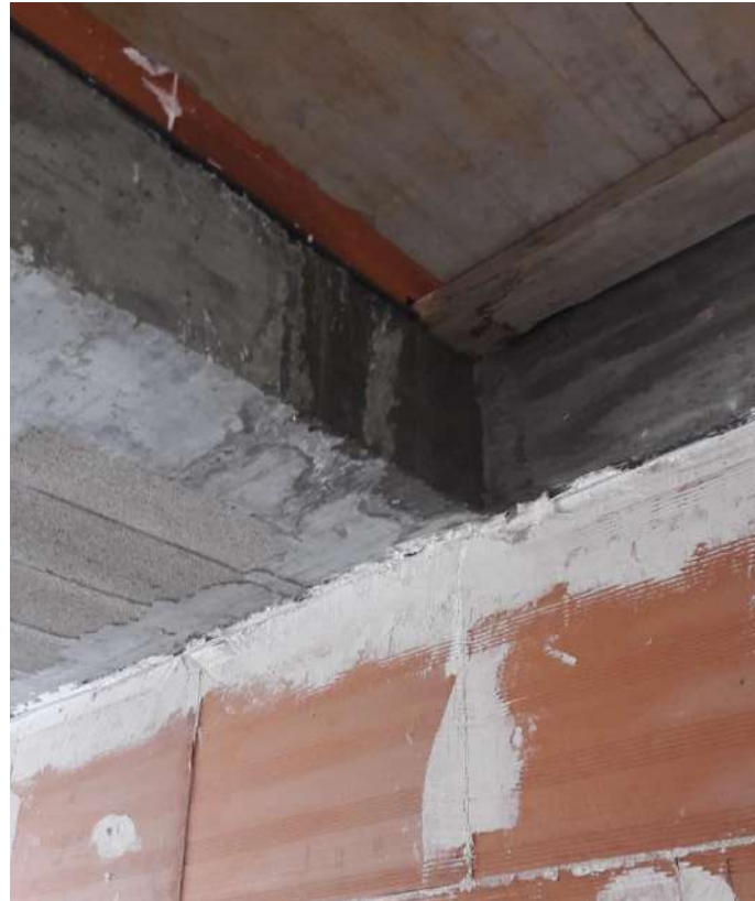
IMAGEN 105: Problemas de gotera en una de las terrazas.
