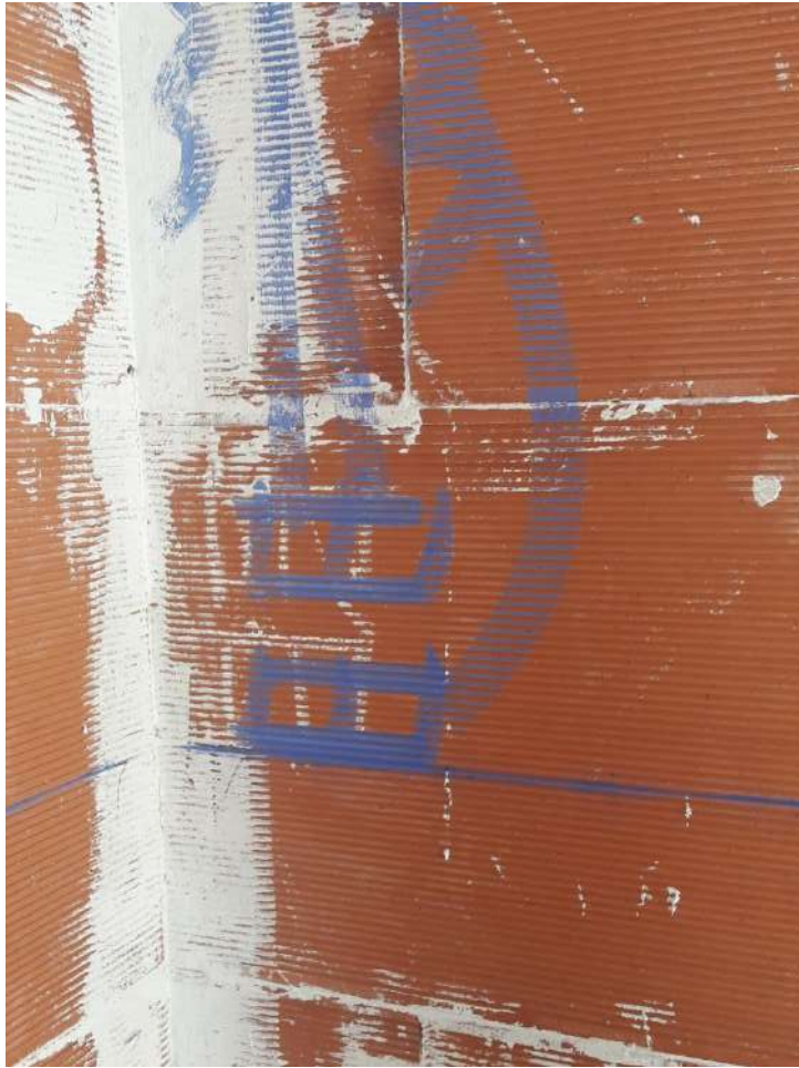
IMAGEN 85: Mal replanteo de los enchufes.
