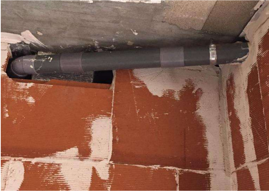
IMAGEN 71: Apaño hecho por el fontanero en la bajante que estaba obstruida de hormigón.
