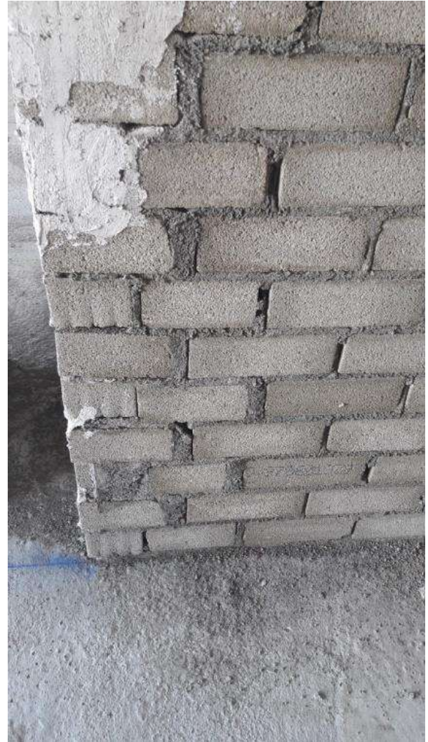
IMAGEN 21: Juntas verticales sin mortero
