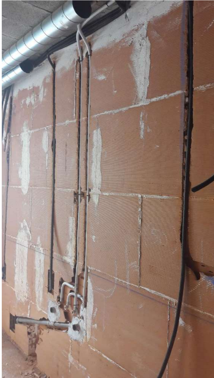
IMAGEN 88: Colocación de parte de las tuberías de fontanería y macarrones de la electricidad.
