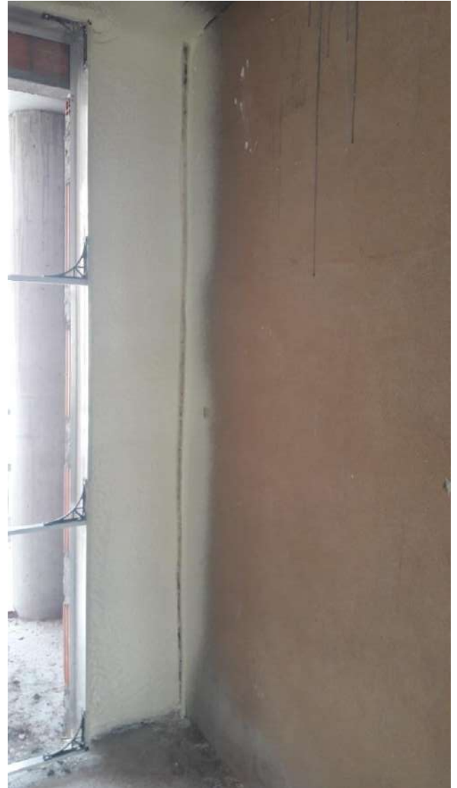
IMAGEN 47: Falta la junta de dilatación
