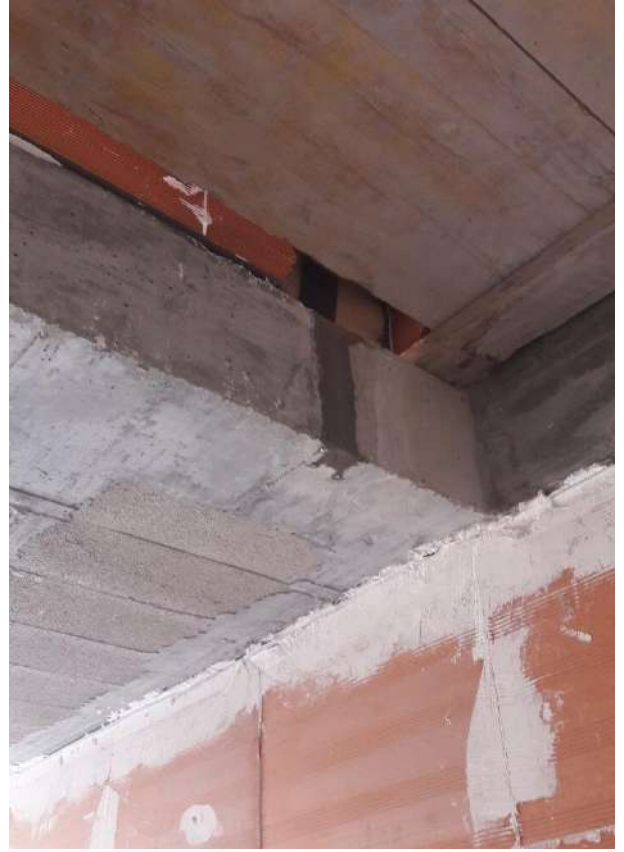
IMAGEN 109: Filtraciones por la cubierta
