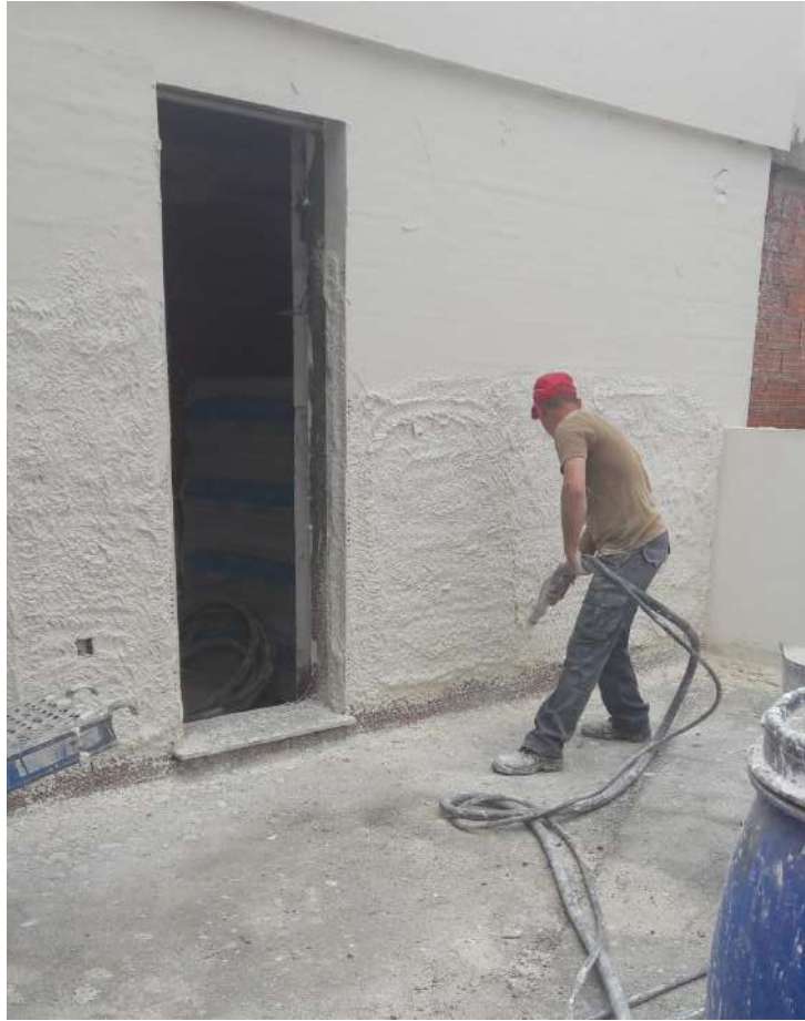
IMAGEN 89: Ejecución del monocapa. Falta de uso del casco de seguridad
