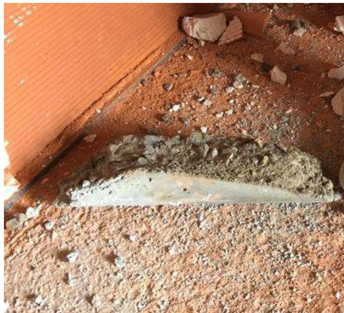
IMAGEN 72: Lo que había en el interior de la bajante obstruida.
