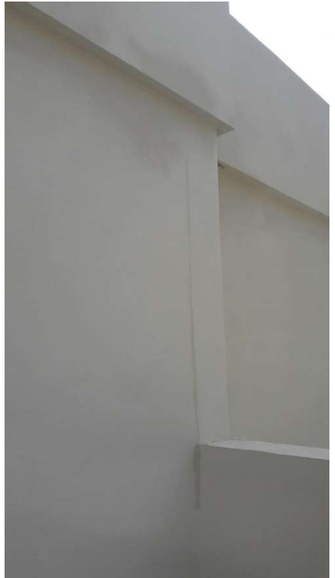
IMAGEN 93: Humedades en el monocapa debido a las fuertes lluvias
