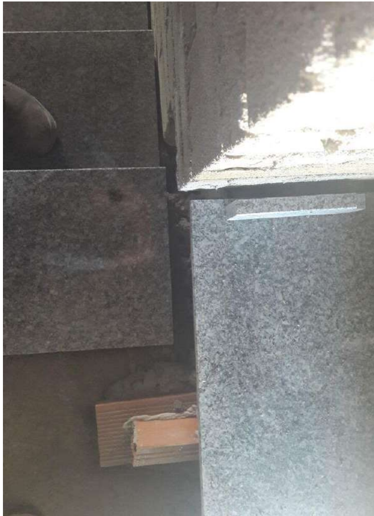
IMAGEN 107: Mala ejecución del último peldaño
