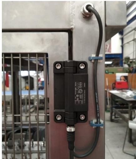
Ilustración 52 Vista interruptor puerta
