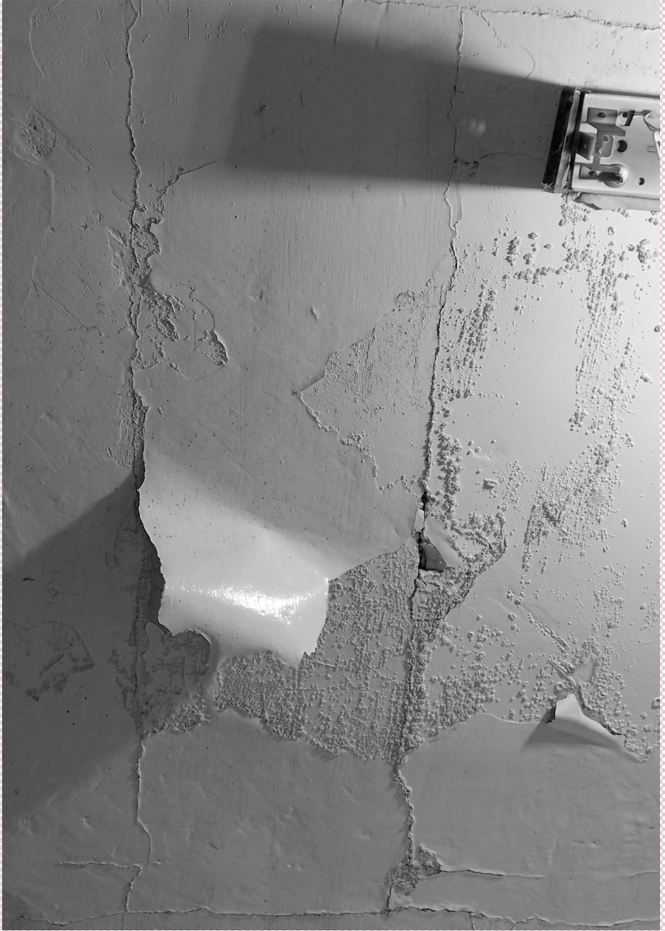
Figura 23. _ 2.2 Humedades en el techo de la cocina
