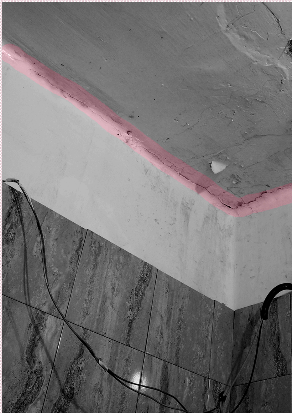
Figura 38. _ 6.1 Fisuras en el perímetro del techo de la cocina
