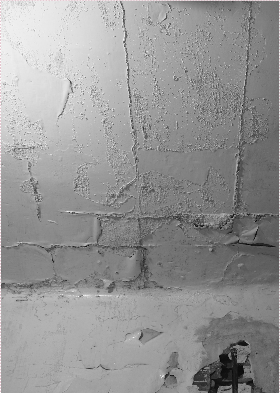
Figura 24. _ 2.2 Humedades en el techo de la cocina
