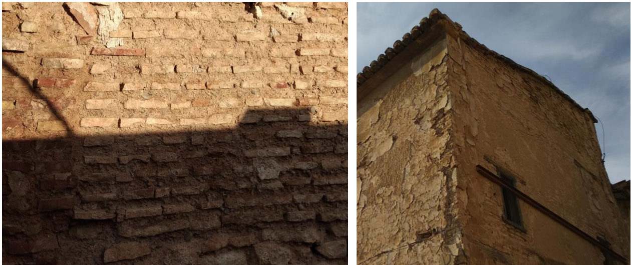
Figura 12. Detalles de muros de tapia valenciana de la Alquería del Moro. Fuente propia.
