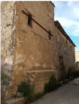
Figura 20. Vista Alzado Este del volumen pral. de La Alquería del Moro. Fuente propia.
