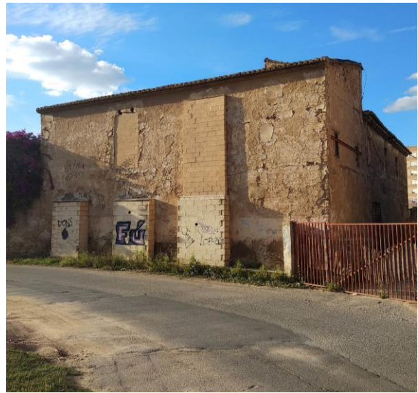
Figura 19. Vista Alzado Sur del volumen principal de La Alquería del Moro. Fuente propia.
