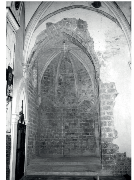
Fig.66. Bóveda simple radial de la capilla del Baptisterio de la iglesia (Puig AMP)
