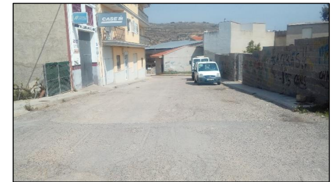
Ilustración 6. Piel de cocodrilo en la calzada en la C/ Serranía
