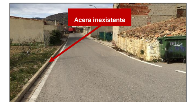
Ilustración 8. Estado de la C/ Serranía, sin acera
