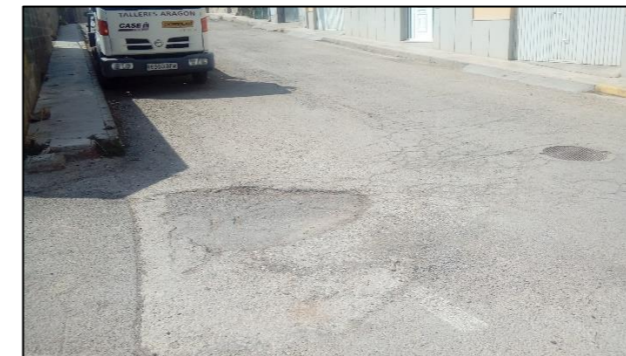
Ilustración 5. Baches en la calzada en la C/ Serranía
