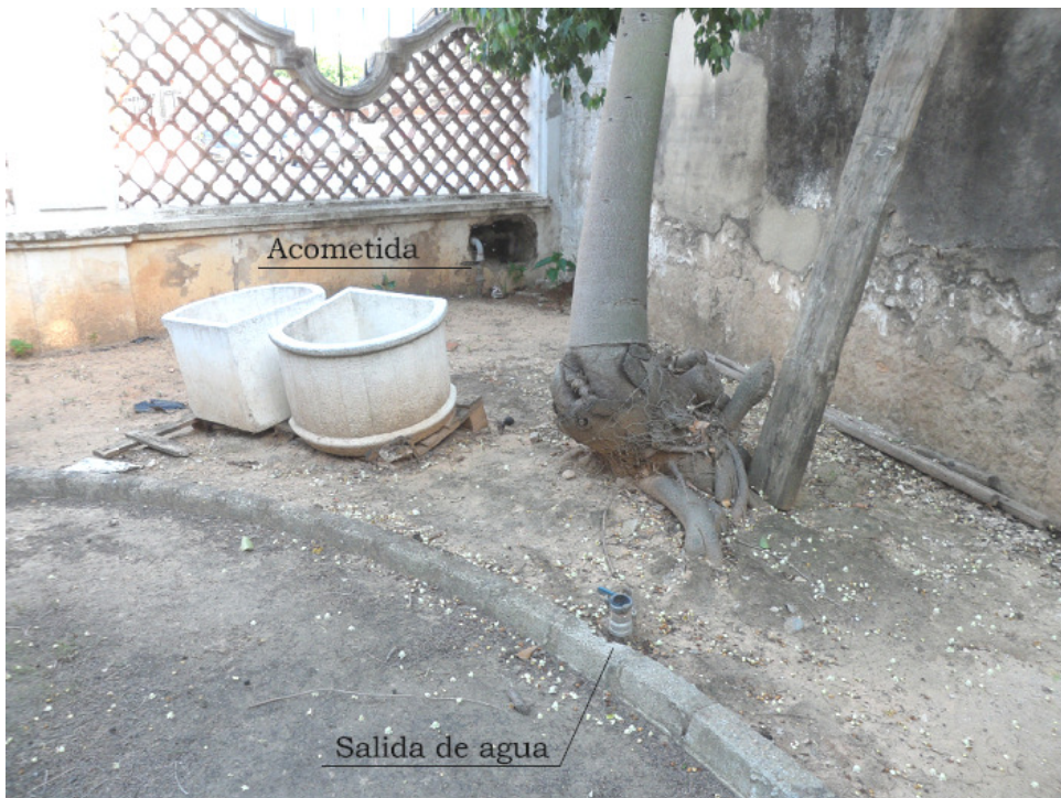
Sistema de riego perimetral
