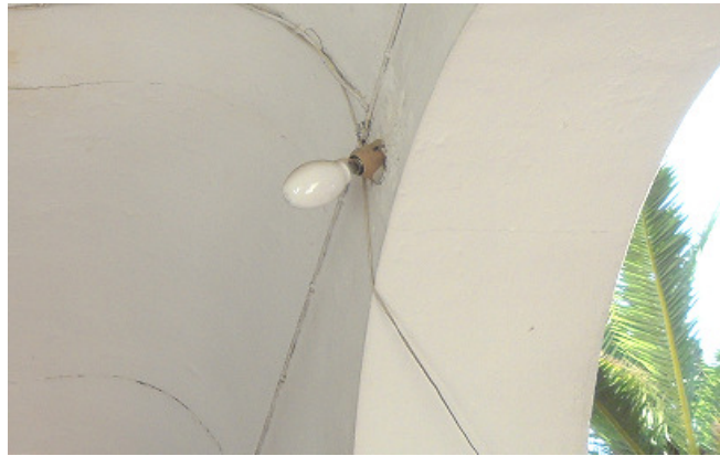
Lámpara iluminación pórtico
