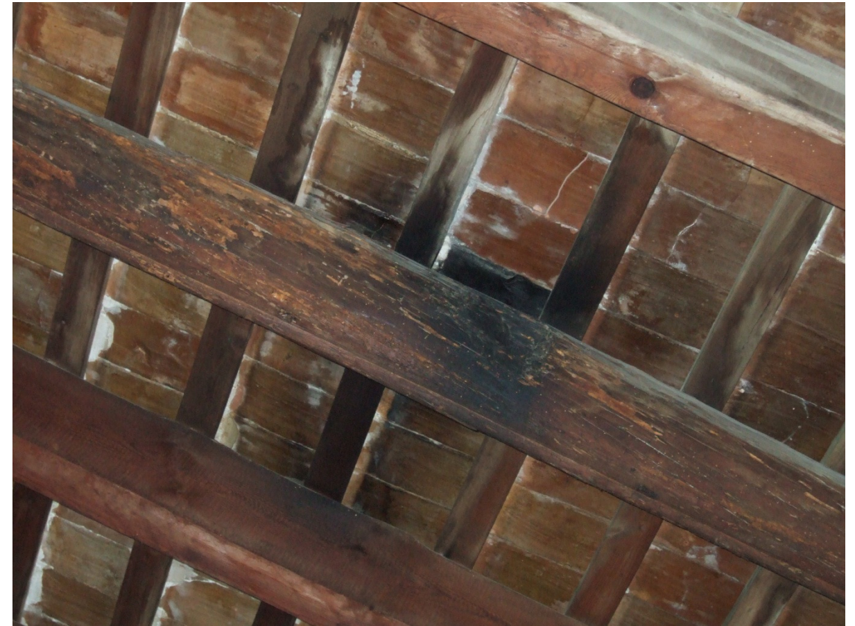
Estructura de cubierta afectada por la humedad procedente de las filtraciones del agua de la lluvia.
