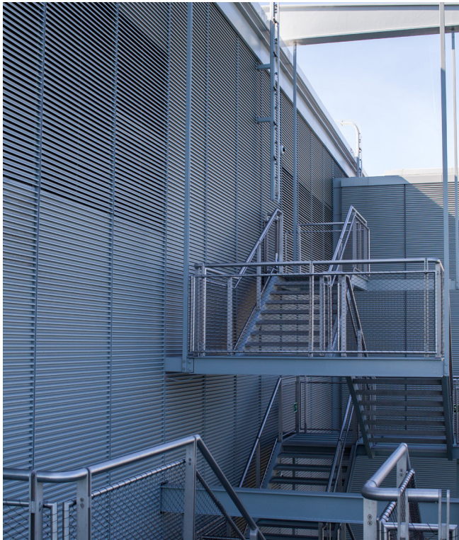
Figura 53: Fachada que oculta los sistemas de instalaciones.
