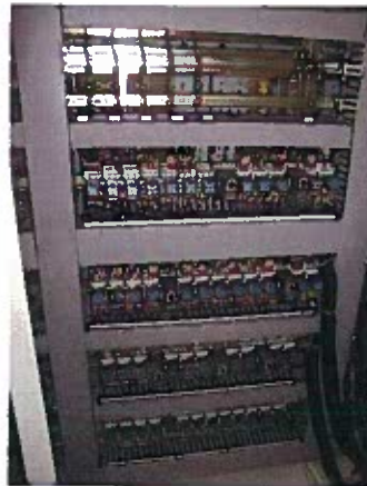
Fig. 3.5 Rack de lógica cableada con relés electromecánicos y temporizados electrónicos
