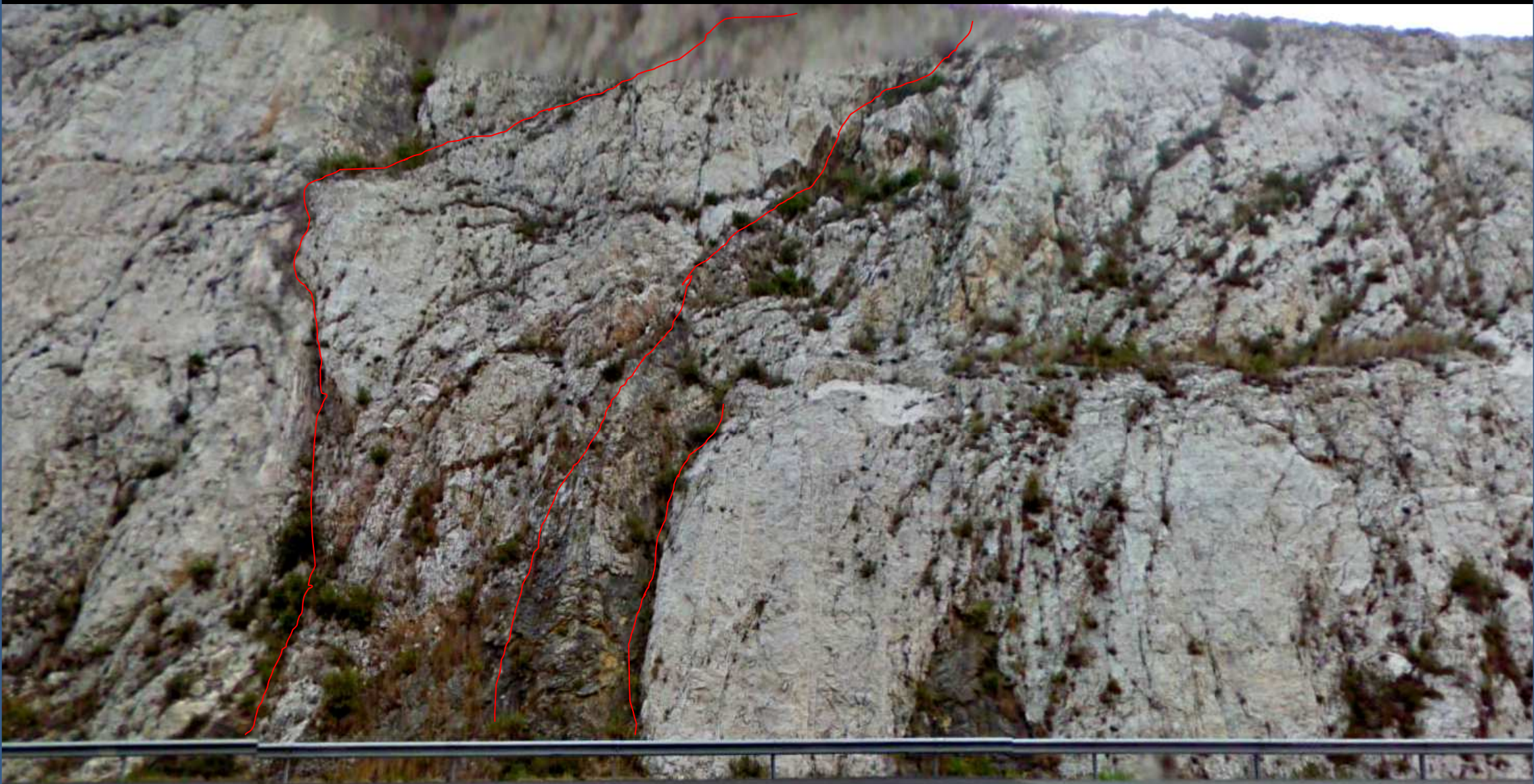
Fracturación intensa , fallas y cierto karst en talud de calizas del Cretácico Sup. Al NW de Gata de Gorgos. Autovía del Mediterráneo. NE Hoja de Benissa.
