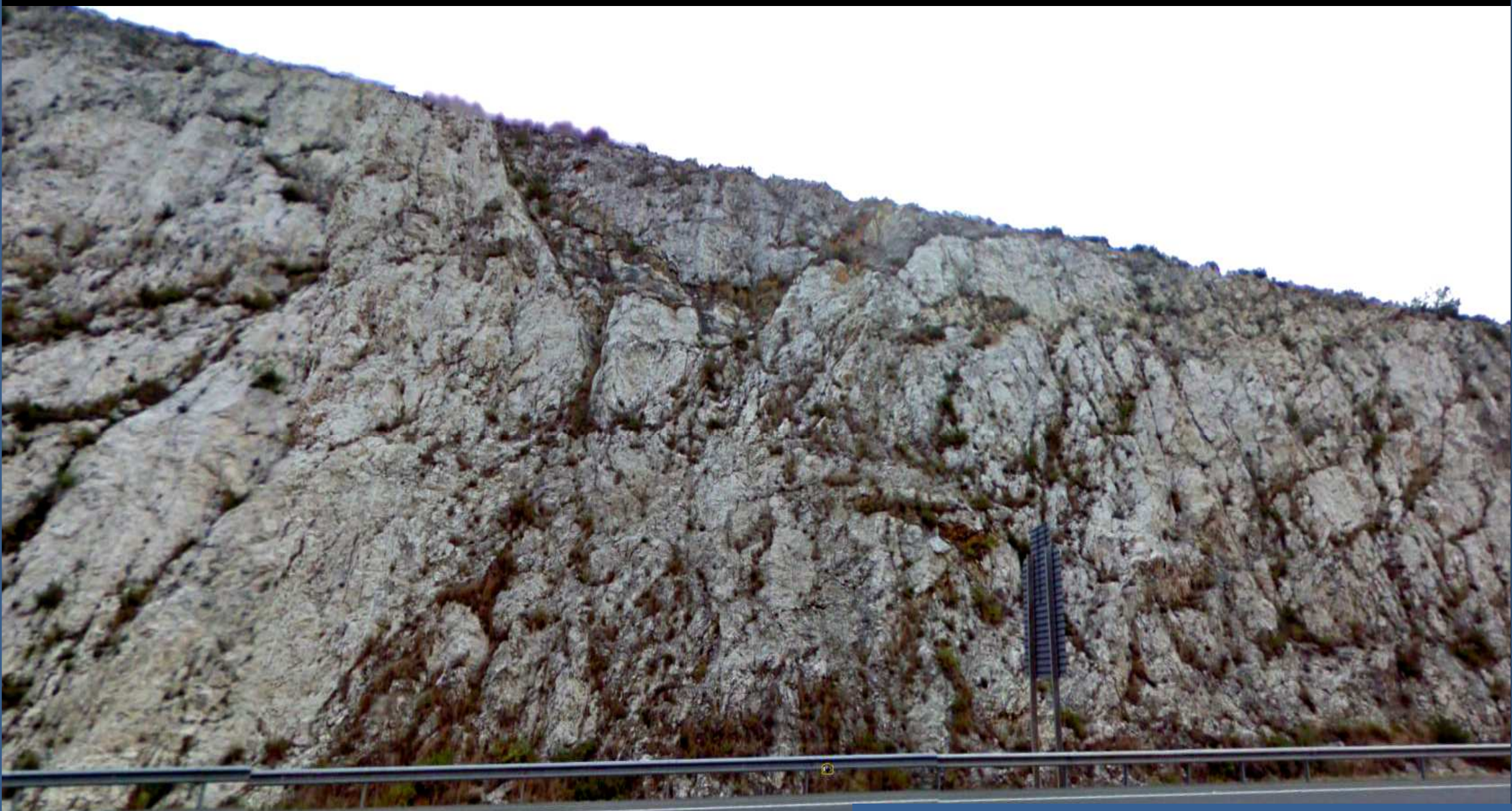
Cambio en la intensidad de fracturación en un talud de calizas del Cretácico Sup. Al NW de Gata de Gorgos. Autovía del Mediterráneo. NE Hoja de Benissa.
