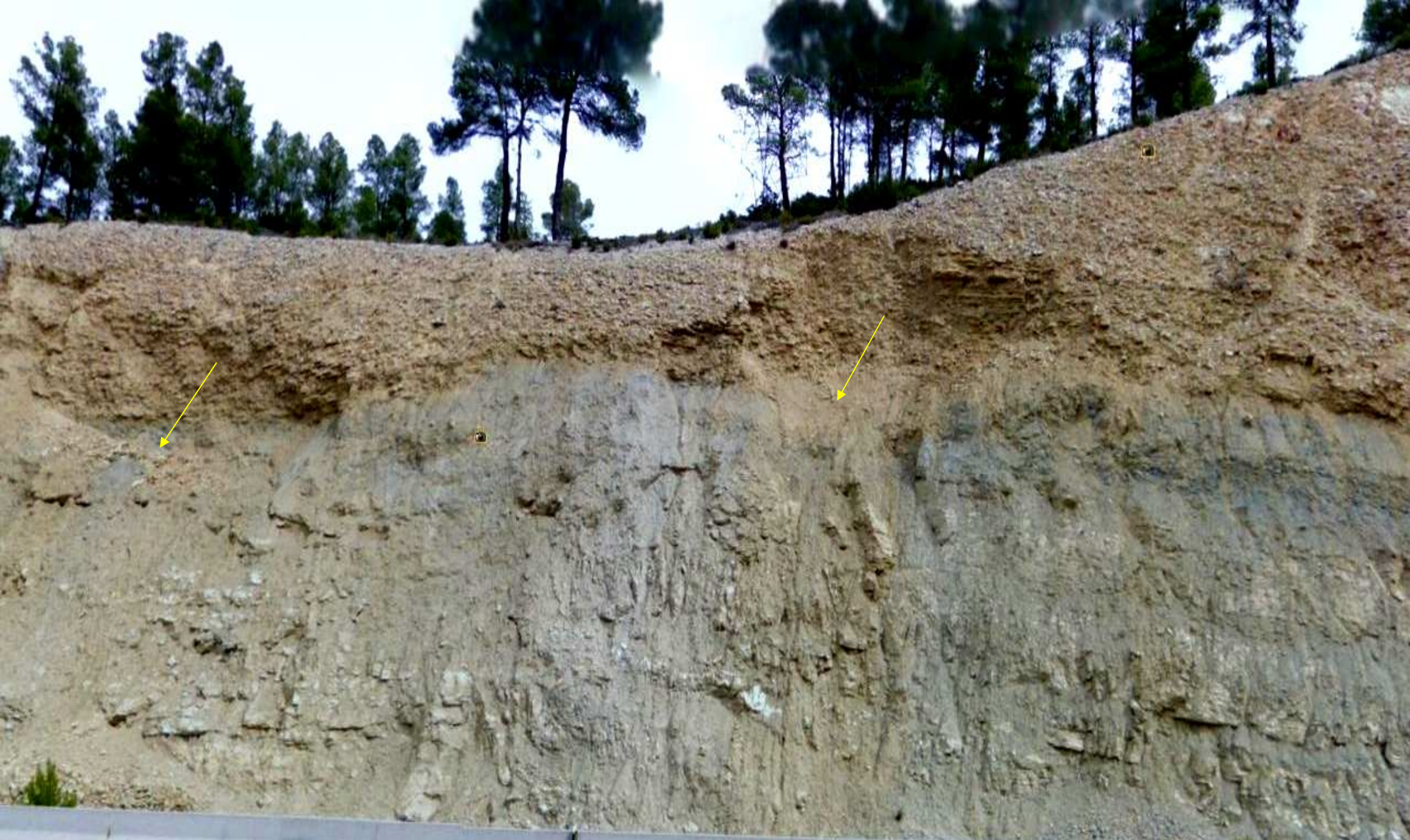
Inestabilidad en talud en dolomías y calizas microcristalinas del Liásico, Jurásico Inf., y en zona de cabalgamiento. Autopista. W de Villagordo del Cabriel. SW Hoja de Utiel
