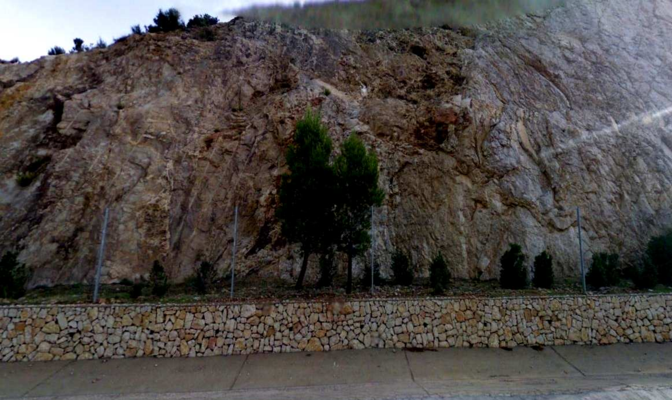
Actuación en talud frente a la inestabilidad. Dolomías y calizas microcristalinas del Liásico, Jurásico Inf., y en zona de cabalgamiento. Autopista. W de Villagordo del Cabriel. SW Hoja de Utiel
