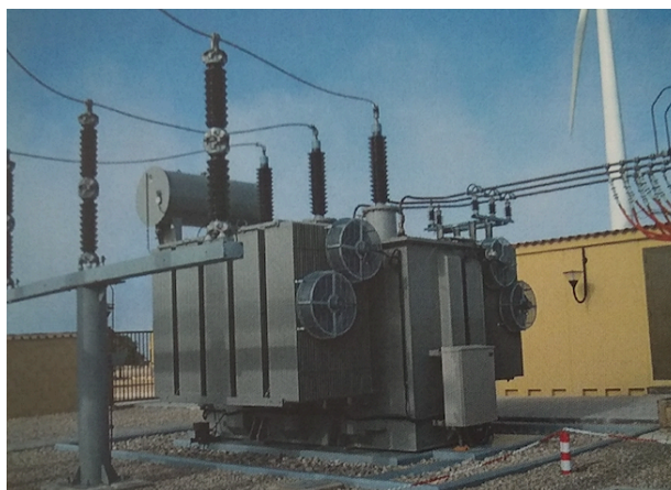
Figura 63. Ejemplo de transformador de potencia 132/20 kV.
