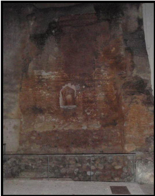
Una de les parets de la muralla que es conserva del que era el pati exterior de la torre
