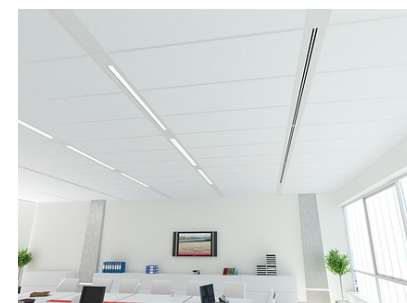
Exemple de l'impacte de la climatització en els falsos sostres
