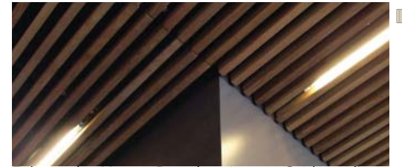
Falso techo Hunter Douglas sistema Grid con listones de madera de haya
