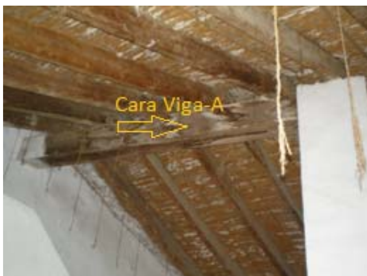
Figura 33. Se observa la cara de la viga A donde se colocaría el equipo.
