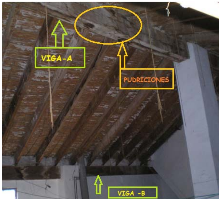
Figura 30. Se observa el forjado de cubierta, la viga A con pudriciones y la viga B.
