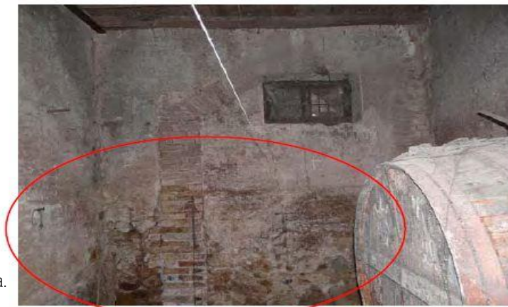
Humedades en la planta baja.
