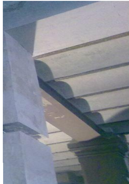
Ejemplo de forjado mediante revoltón y vigas de madera de la planta baja.
