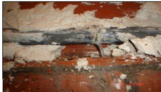
Tuberías de plomo.
