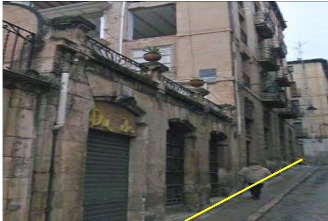
Desnivel en fachada que da a la Calle Goya.
