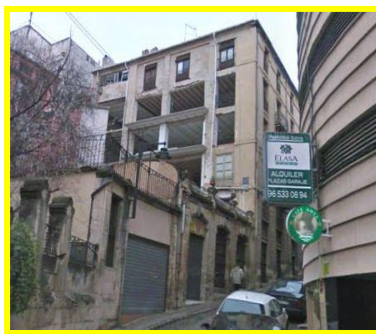
Medianera que realiza las funciones de otra fachada, con un patio de dimensiones considerables
