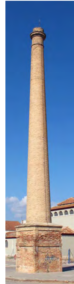
Figura 3.4: Vista general de la chimenea, en su lado Sur, antes de la restauración.
