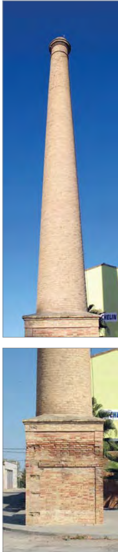
IMATGES DE PATOLOGIES
