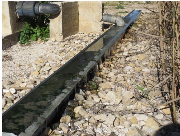
Figura 32. Distribución de agua a través de canales abiertos (Hernández Crespo & Martín Monerris, 2018)
